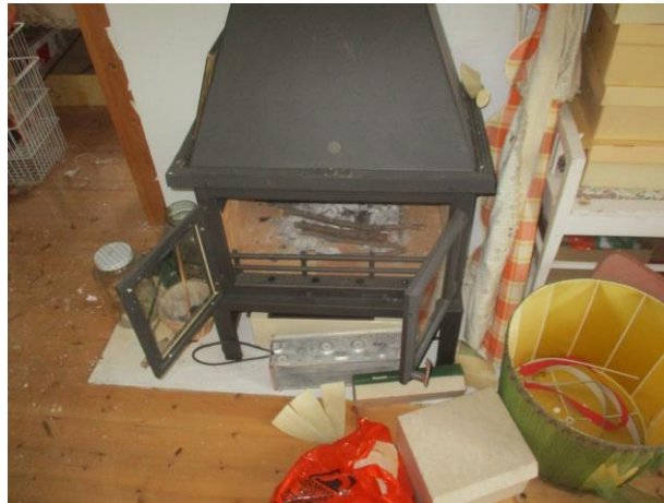
Kuva 12b. Kipinäsuojaus on takan edustalle asennamatta.
