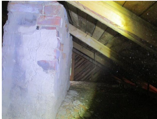
Kuva 4c. Hormissa oli havaittavissa rappauksen irtaamista sekä kosteusjälkiä.
