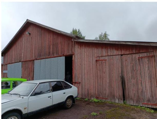
Kuva 3b. Huonokuntoinen puuovi (oikealla).
