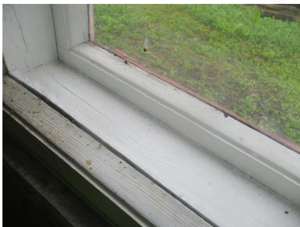
Kuva 3c. Ikkunan välissä ei havaittu huurtumista tarkastushetkellä.
