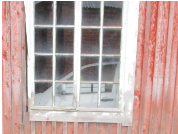
Kuva 3d. Ikkunapuitteet ja vuorilaudoitukset ovat peruskunnostuksen tarpeessa.
