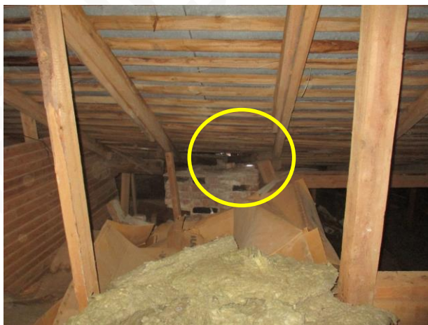
Kuva 4h. Reikä vesikatteessa.
