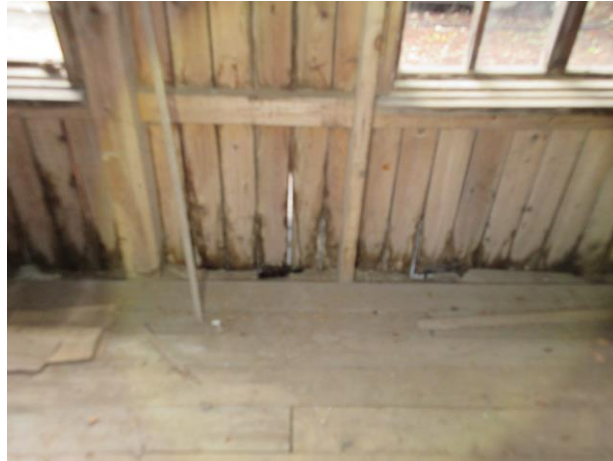
Kuva 2e. Sade ohjautuu verhouksen läpi sisätiloihin.
