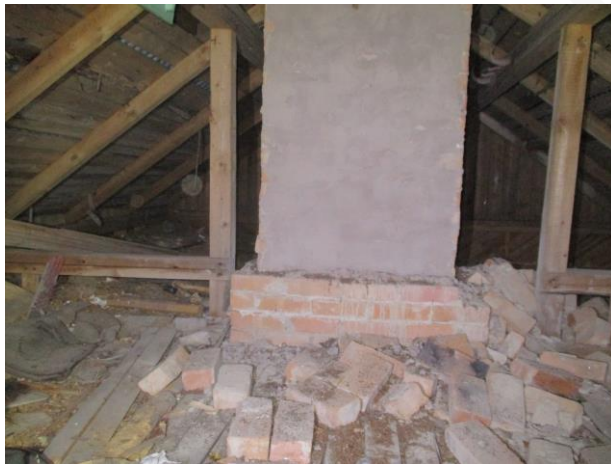
Kuva 4e. Palokuormaa ja jätettä ullakolla.
