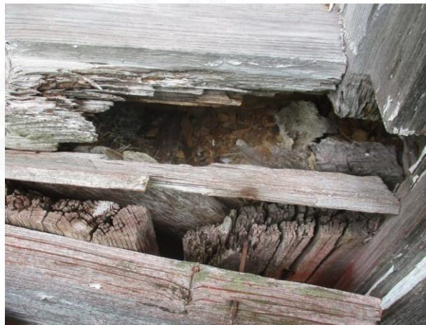
Kuva 2c. Vaurio seinärakenteessa ja ikkunan karmissa.
