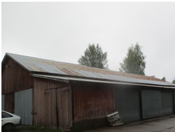
Kuva 4a. Katteessa on korroosiota laajalla alueella.
