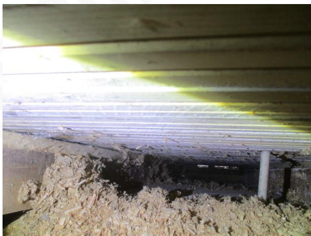
Kuva 2c. Rakennuksen päätyjä ei ole eristetty.
