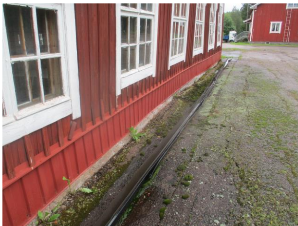
Kuva 2b. Verhouksen alaosaa oli pellitetty.
