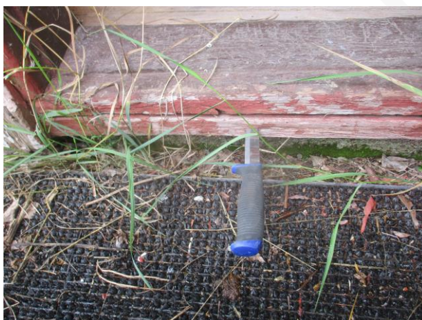
Kuva 2b. Myös ovien kynnyksissä oli havaittavissa lahoa.
