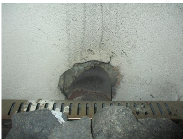
Kuva 5.2c. Palohormin läpivienti, peitelaippa puutuu.
