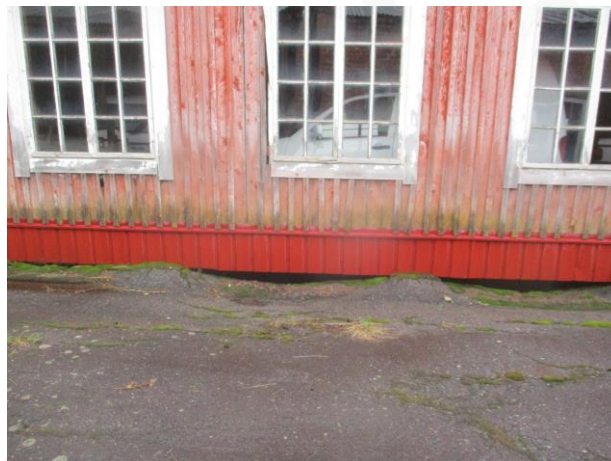
Kuva 1a. Rakennuksen vierustaa. Routiminen on nostanut asfalttia.
