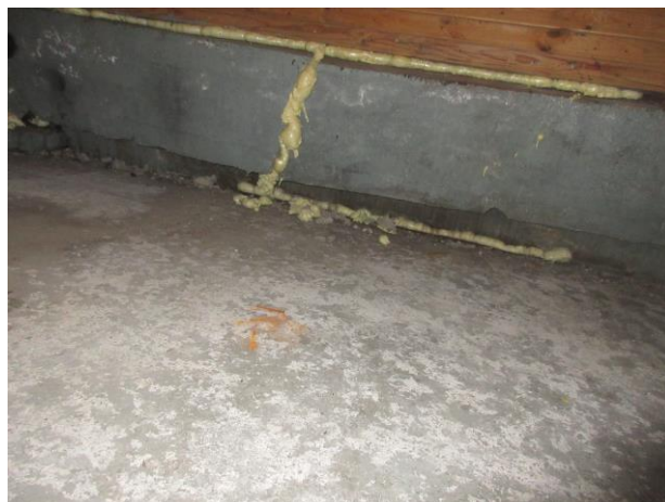
Kuva 1h. Sokkelissa oli halkeamia.
