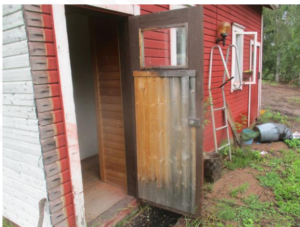
Kuva 3d. Ulko-ovet ovat kosteusvaurioituneet ja osin lahonneet.
