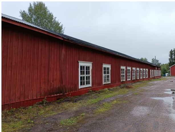
Kuva 2e. Yleiskuvaa verhouksesta. Kosteusjälkiä verhouksen alaosissa.
