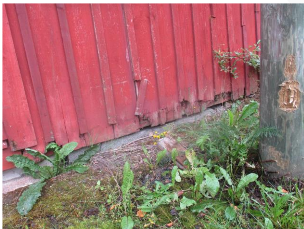
Kuva 2f. Laudoituksen alaosissa on lahoa.
