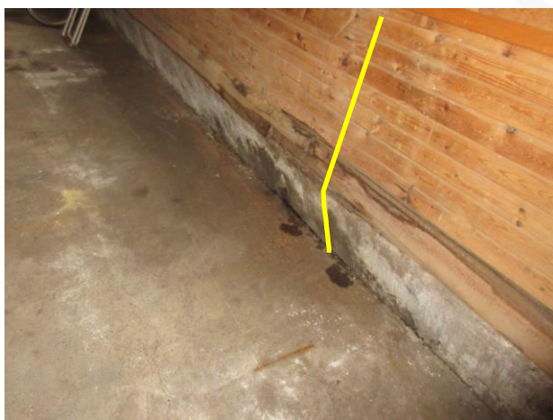
Kuva 1c. Nurjautaminen, jota on viivalla havainnoin helpottamiseksi tehostettu. Maapohjasta sokkelin ja laatan alta johtuu irtovettä.
