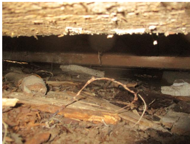
Kuva 1c. Alapohjatila on matala. Orgaanista jätettä maapohjassa.
