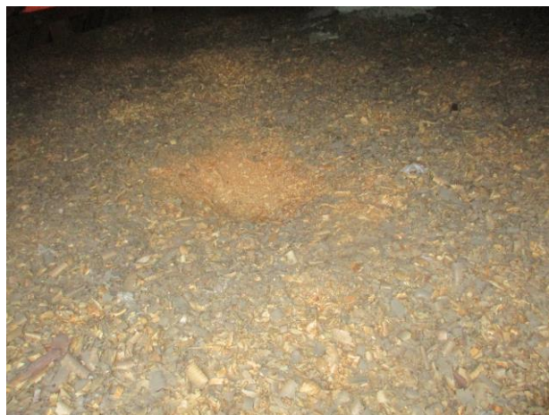
Kuva 4e. Purueriste valunut väliseinärakenteeseen.
