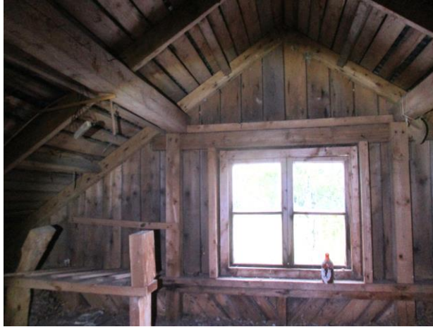
Kuva 4d. Päätylaudoitusta. Päätytuuletusventiiliä ei ole asennettu.
