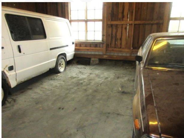
Kuva 2g. Viistosade on tunkeutunut lomarimalaudituksen raoista sisäpuolelle.
