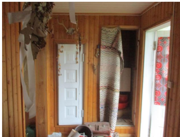
Kuva 6c. Eteistilaa. Ullakkoportaikon ovi puuttuu.
