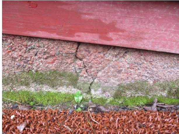
Kuva 1b. Sokkelissa oli havaittavissa halkeamia.
