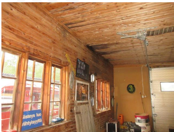
Kuva 4e. Akuutti kosteusvauriokohta, joka ulottuu myös seinärakenteeseen.
