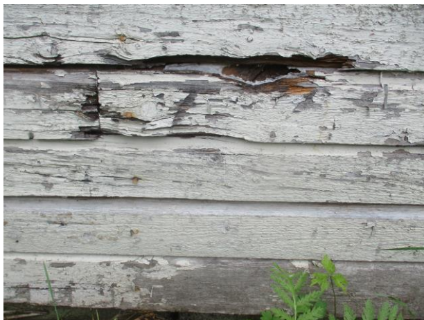
Kuva 2a. Julkisivussa on paikoin lahoa.
