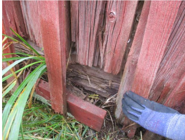
Kuva 1b. Lahovaurio rungon alaosassa.
