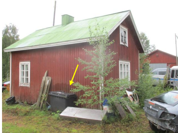
Kuva 2d. Julkisivuverhous kastuu sateella puuttuvista vesikouruista ja rakennuksen vierustalle varastoidusta materiaalista johtuen
