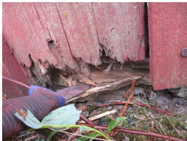
Kuva 1j. Rungon alaosissa todettiin lahoa.
