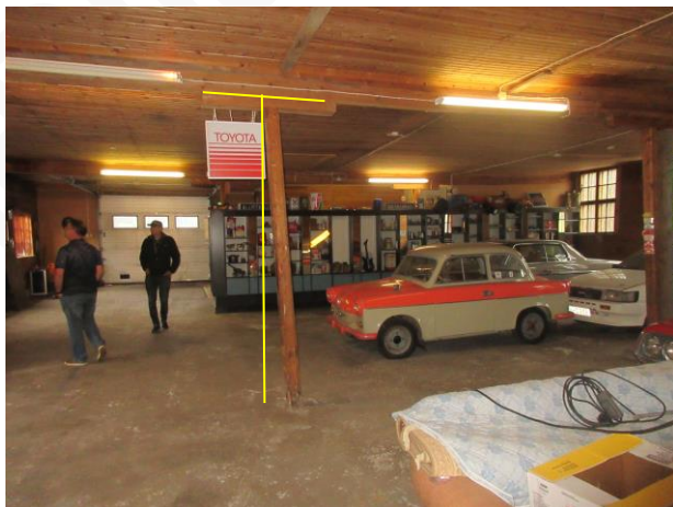
Kuva 1d. Pilarin nurjautustarkastelunkin perusteella rakennuksessa on kokonaiskallistuma. Kantavat rakenteet ovat siis kallistuneet joen puoleiselle sivulle.
