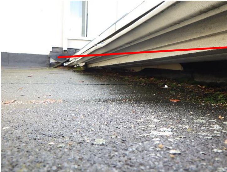
Kuva 243. Sadeveden poisohjaus ylemmältä vesikattolta on puutteellinen
