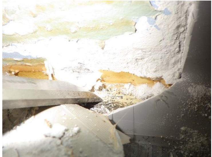
Kuva 44. Tiivistyskorjauksessa jalkalistan alla oleva alapohjan ja ulkoseinän liitos on tiivistyskorjattu vedeneristeellä kiinnitetyllä vahvikenauhalla.
