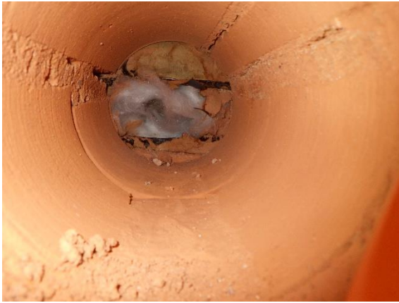
Kuva 72. Rakenneavaus RA-US9. Ulkoseinän kuorimuurauksen takana on tervaperilla päällystettyä lasivillaa.
