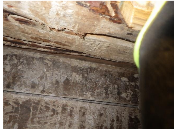
Kuva 162. Rakenneavaus RA-VP6. Alalaattapalkiston ontelotilassa on rakennusjätettä sekä rakennusvaiheen muottilaudat.
