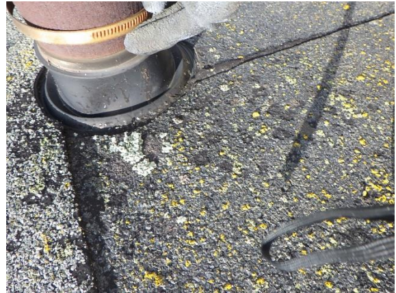
Kuva 248. Läpivientikappaleen kiristyspanta on löystynyt.
