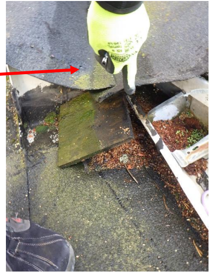
Kuva 244. Sadeveden ohjautumista on pyritty parantamaan tarkoitukseen soveltumattomalla vaneripalalla.
