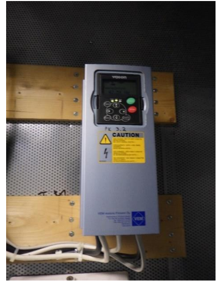
Kuva 275. Tuloilmakoneistoon TK3 on asennettu taajuusmuuttaja vuonna 2014 ja koneisto on liitetty etäohjattavaan kiinteistöautomaatioon.
