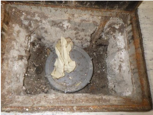
Kuva 37. Tilan 1135 alapohjarakenteessa oleva viemäriputkiston tarkastusluukku ei ole ilmatiivis ja sen kautta on mahdollista tulla vuotoilmaa alapohjan täyttömaasta.
