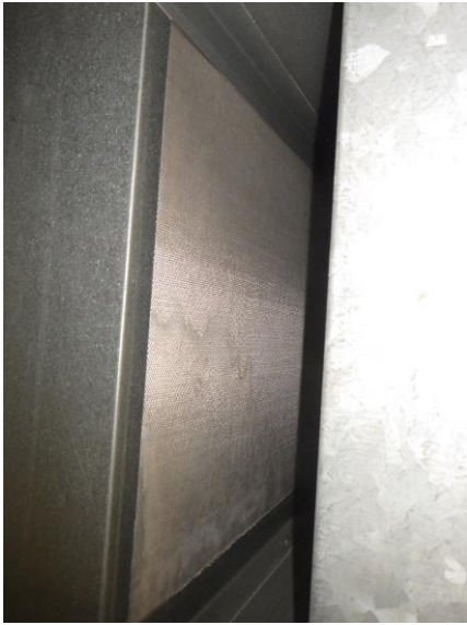
Kuva 276. Tuloilmakoneiston TK1 lamelinäänenvaimentimet ovat pinnoitettua mineraalivillaa. Äänenvaimentimien pinnoite / kangas oli havaintojen perusteella ehjä.
