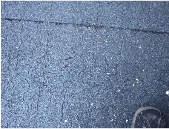
Kuva 239. Vesikatteen pintakermissä on ikääntymisen merkkeinä pintakerroksen halkeilua.
