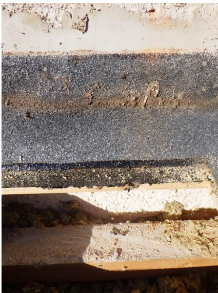
Kuva 203. Yläpohjarakenne ei tuuletu rintataitteen kautta, koska vesikate on liimattu vasten korkeamman osan ulkoseinää.
