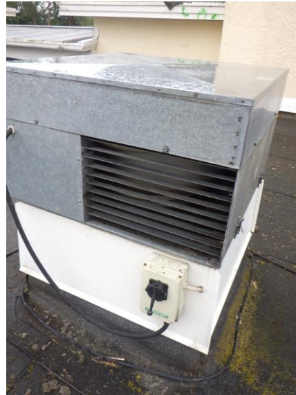
Kuva 283. Keittiön alkuperäinen poistoilmahuuhallin.
