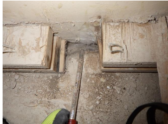
Kuva 51. Alapohjalaatan ja liikuntasalin kantavan seinän liitoksessa on näkyvää betonin kuivumiskutistuma. Merkkisavukokeen perusteella liitoskohdasta tuli vuotoilmaa.
