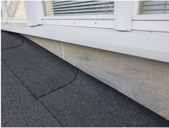
Kuva 127. Ulkoseinärakenteen US8 toisen kerroksen julkisivuna olevan kivisirotepintaisen julkisivulevyn kunto on välttävä länsisivulla. Julkisivusta irtoaa kivisirotta.
