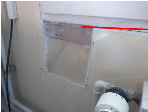
Kuva 142. Höyrysulkuna oleva rakennusmuovia ei ole liitetty ilmatiiviisti ikkunakarmin.
