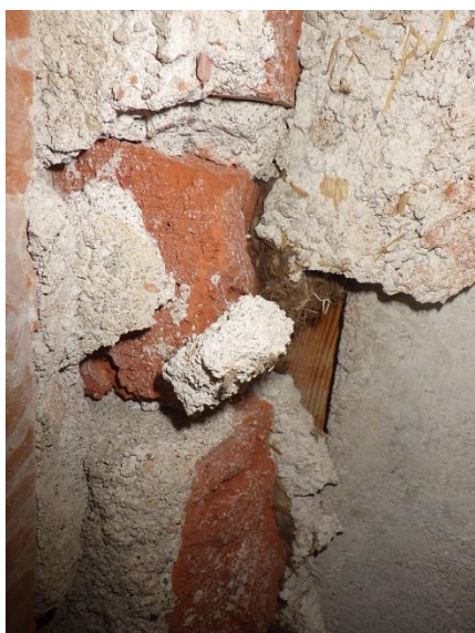
Kuva 185. Puretun kuorimuurauksen takana olevaa massiivitiiliseinää ei ole puhdistettu. Ikkunoiden tilke-eristeenä olleet pellavariveet ovat jääneet rakenteeseen.
