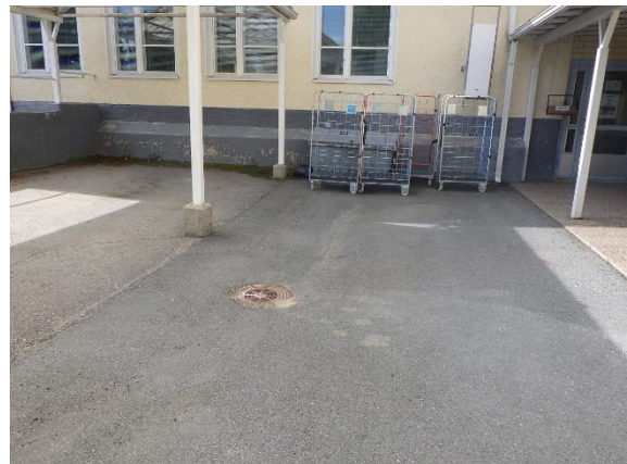
Kuva 68. Itäisivulla on perustuksia tukeva betonimantteli, koska ympäröivää maanpintaa on madallettu lähelle perustamistasoa. Manttelin maalipinta on huonokuntoinen.
