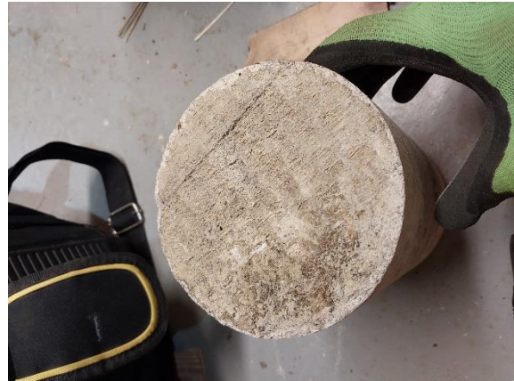
Kuva 55. Maanvastaisen seinän ulkopinnassa on alkuperäinen bitumisively kosteudeneristeenä.
