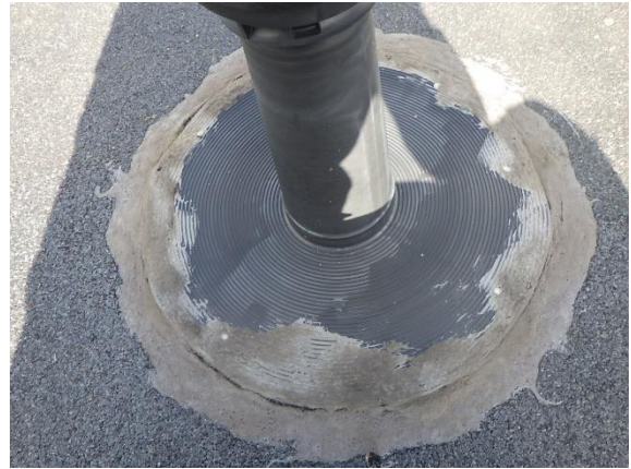
Kuva 256. Jälkiasenteinen läpivientikap- pale on altis vesikattovuodolle.
