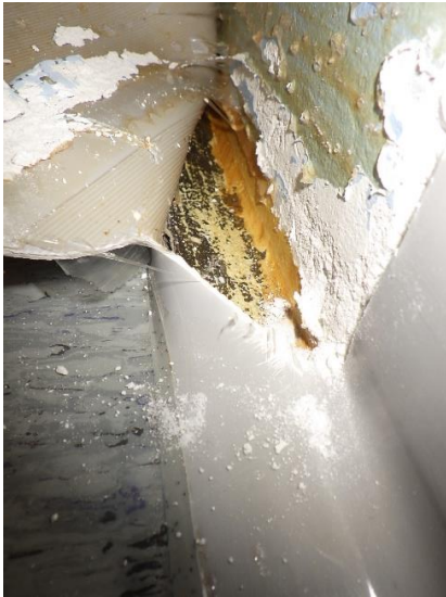
Kuva 43. Alapohjan AP5 tiivistyskorjatulla alueella muovisen jalkalistan ja muovimaton liitos on hitsattu. Jalkalistat on nostettu seinälle liimamalla.
