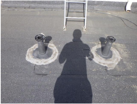
Kuva 255. Ruokalan vesikaton alipai- neventtileistä puuttuu sadesuojat.
