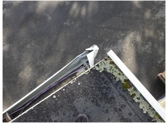
Kuva 240. Räystäskourun päässä on paikallinen vaurio.
