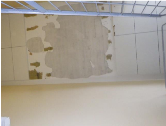
Kuva 195. Yläpohjarakenteen alapinnasta puuttuu akustolevyjä portaikon kohdalla.
