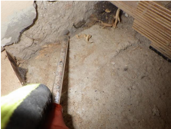
Kuva 50. Alapohjalaatan ja liikuntasalin kantavan seinän liitoksessa on näkyvää betonin kuivumiskutistuma. Merkkisavukokeen perusteella liitoskohdasta tuli vuotoilmaa.
