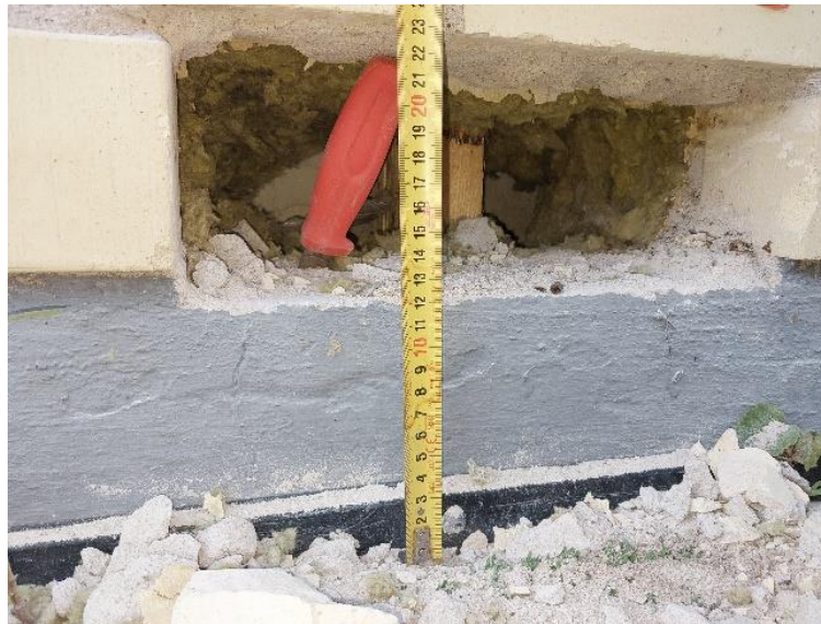
Kuva 99. Rakennusaukko RA-US19. Ulkoseinän ala- sidepuu on noin 100 mm maanpinnan yläpuolella.
