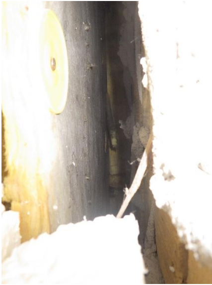
Kuva 137. Rakenneavaus RA-US5. kuorimuurauksen ja tuulensuojavillan välissä on reilu tuuletusväli. Välissä ei ole merkittävästi muurauslaastipurseita.
