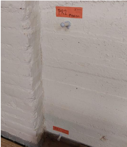
Kuva 57. Maanvastainen seinärakenne KS1. Alhaalla porareikämittaus PR1 ja ylempänä PR2. Porareikien syvyys 50 mm.
