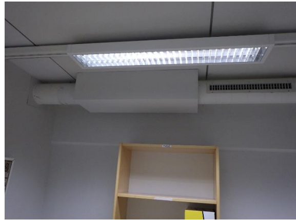
Kuva 287. Ilmanvaihtojärjestelmän mahdollinen sisäilman mineraalikuitulähde on kanavavaimentimien äänieristeet, joita ei pystytty tarkistamaan kuntotutkimuksissa.
