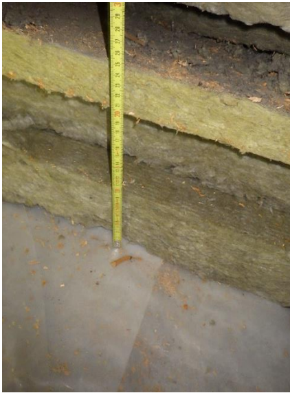
Kuva 210. Yläpohjarakenteessa YP5 on räystäiden läheisyydessä mineraalivillieristys 120 mm + 120 mm sekä ulkopinnassa 50 mm tuulensuojavilla.
