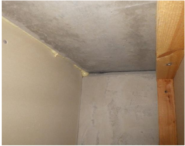
Kuva 107. Ulkoseinän tiivistyskorjausta ei ole tehty talotekniikkakotelon sisäpuolelle.
