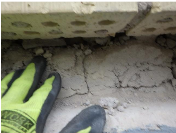
Kuva 117. Rakenneavaus RA-US1. Kuorimuurausten takana olevassa ilmvälissä on muurauslaastipurseita.
