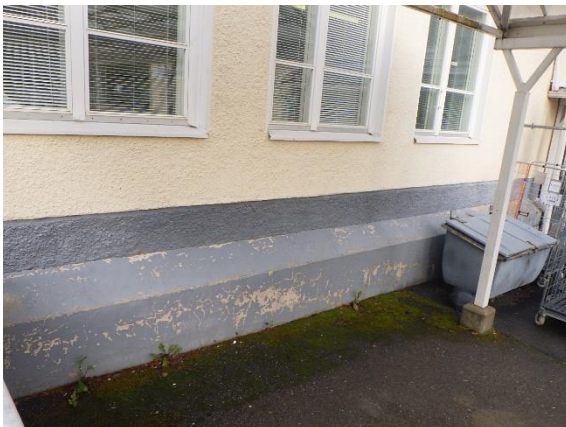
Kuva 67. Itäisivulla on perustuksia tukeva betonimantteli, koska ympäröivää maanpintaa on madallettu lähelle perustamistasoa. Manttelin maalipinta on huonokuntoinen.
