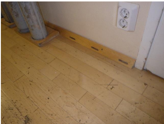
Kuva 52. Liikuntasalin puulattian jalkalistoissa on tuuletusreiät, joiden kautta on ilmayhteys lattian koolaustilasta sisäilmaan.
