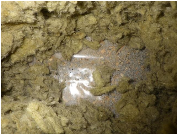
Kuva 212. Rakennusmuovin ja ontelolaatan välissä on rakennusaikaista sahanpurua ja rakennusjätettä.
