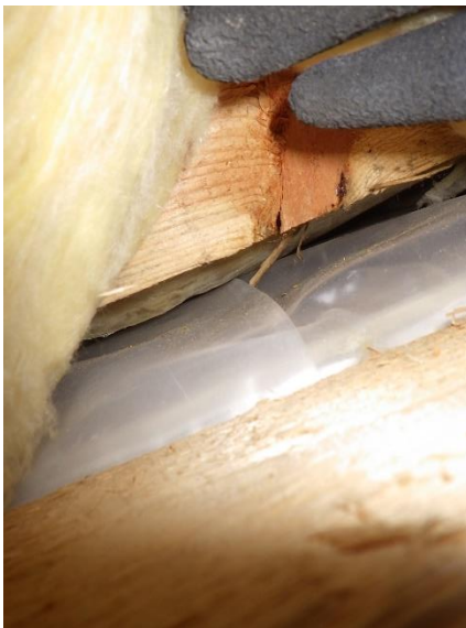
Kuva 223. Rakennusmuovin limityksiä ei ole teipattu.
