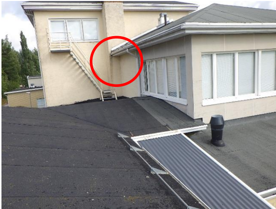
Kuva 69. Eteläpäädyssä kaksikerroksisen osan vesikatolta valuu vesiä julkisivulle räystäskourujen ylitse.
