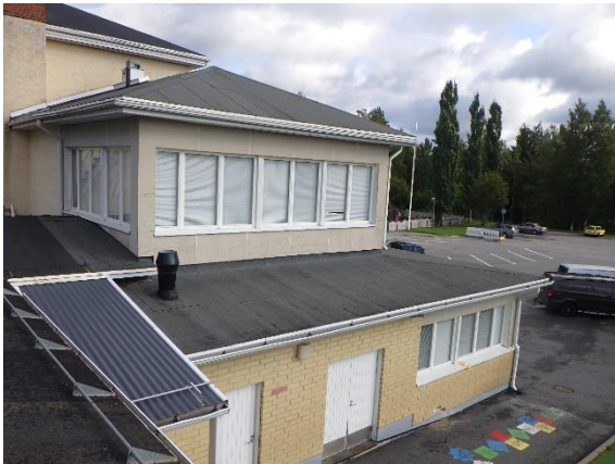
Kuva 272. Vesikatteella ei ole lumiasteita kulkuväylän kohdalla.
