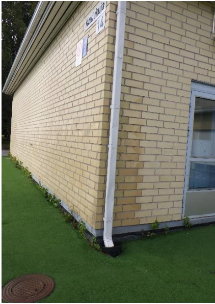
Kuva 88. Rakennuksen eteläpäädyn kuorimuurauksessa / julkisivussa on näkyvää kosteusrasitusta.
