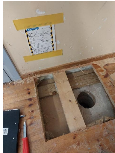
Kuva 21. Puulattia ei liity ilmatiiviisti seinärakenteisiin, joten puulattian alla olevasta koolaustilasta on merkittäviä ilma- vuotoja sisäilmaan.
