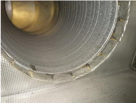
Kuva 278. Tuloilmakoneen TK2 ilmanjakokammion reikäpellityksen takana näkyvässä mineraalivillaeristys. Eristyksestä on mahdollista irrota mineraalikuituja tuloilmaan.
