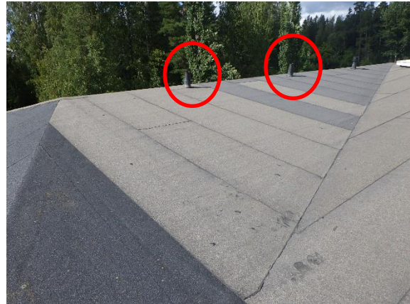
Kuva 252. Useasta liikuntasalin vesikaton alipaineventtiilistä puuttuu sadesuojat.
