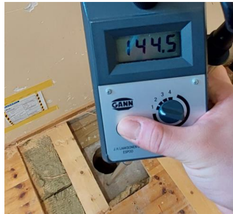
Kuva 19. Pintakosteudentunnistimen arvot viittaavat teräsbetonilaatan yläpinnan olevan kostea/märkä.
