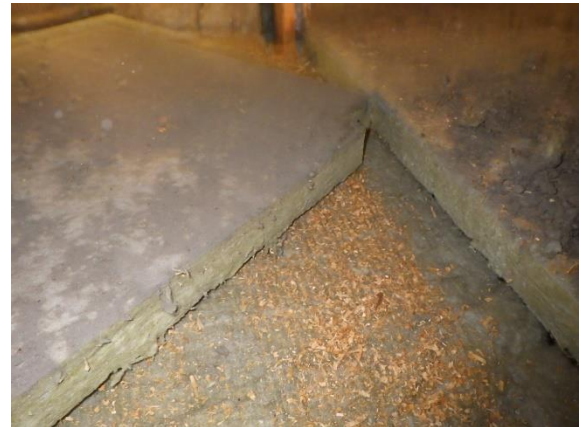
Kuva 213. Puhallusvillan ja tuulensuojalevyn välissä on sahanpurua.
