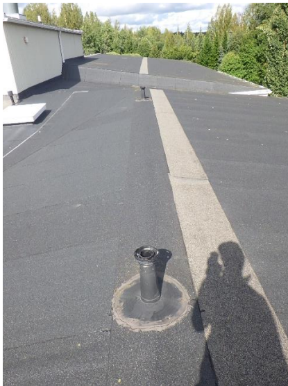
Kuva 263. Alipaineventtiileistä puuttuu sadesuojat.
