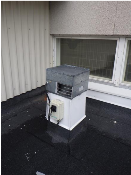
Kuva 282. Alkuperäinen liikuntasalin märkätilojen poistoilmahuuhallin.
