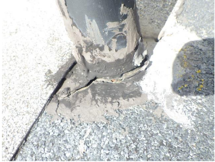
Kuva 268. Alipaineventtiilin liitos vesikatteeseen on aistinvaraisesti arvioituna epätiivis.
