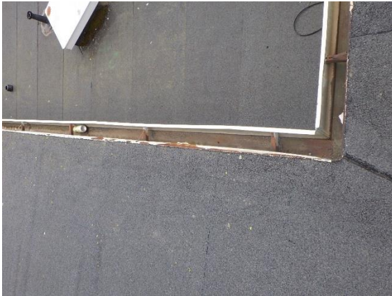
Kuva 251. Räystäskourujen kiinnikkeet ovat ruostuneet.
