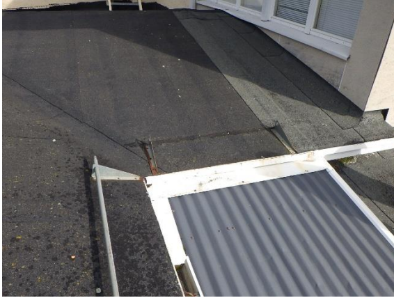
Kuva 270. Lumiasteen vaakaputki puuttuu sisäänkäyntikatoksen kohdalla.
