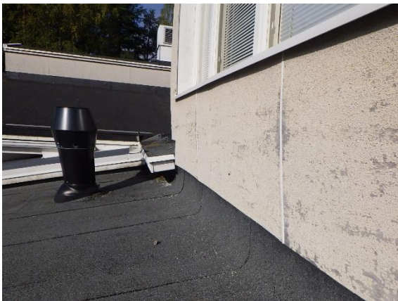
Kuva 129. Eteläpään julkisivulevystä irtoaa kivisirote. Julkisivun kunto on välttävä.
