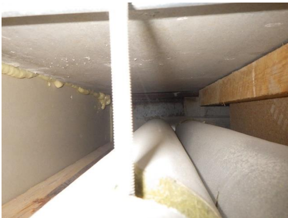
Kuva 102. Kuva talotekniikkakoteloinnin sisäpuolelta.
