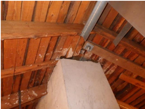
Kuva 200. Savuhormi on katkaistu vesikatteen alapuolelle. Vesikattorakenteet jatkuvat yhtenäisenä vanhan hormirakenteen yli.
