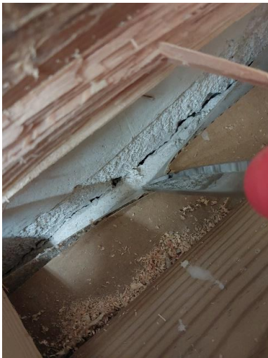
Kuva 20. Kuva rakennearvauksesta RA-AP10. Näkyvä betonilaatan kuivumiskutistumasta aiheutunut vuotokohta ulkoseinän ja alapohjan liitoksessa.
