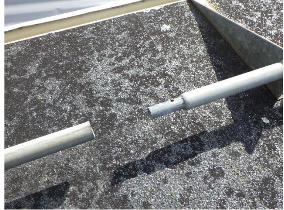
Kuva 271. Lumiasteen vaakaputki irronnut.
