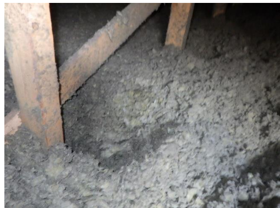
Kuva 266. Yläpohjan lämmöneristekerros on kastunut alipaineventtiilin kohdalla.
