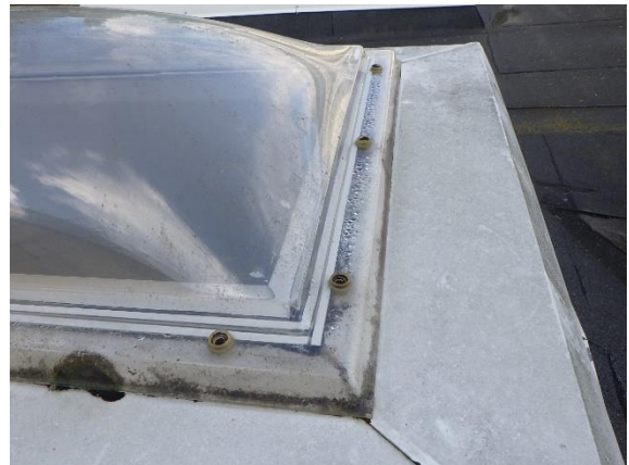
Kuva 258. Kupuikkunoiden kiinnitysruu- vien sadesuojia on rikkoutunut.
