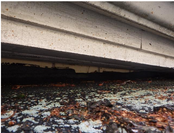
Kuva 245. Katoksen vesikatteen ylösnosto viereisen osan räystäsrakenteen alla on altis vesikattovuodolle.
