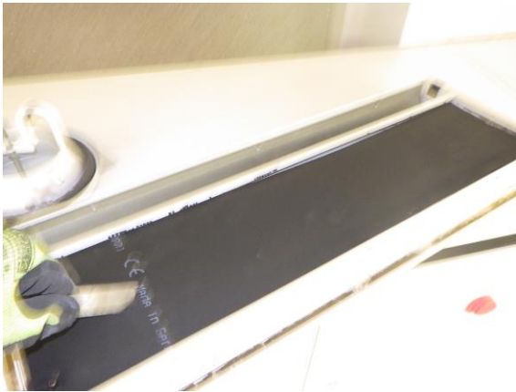
Kuva 286. Tuloilmapäätte-elimien äänieristeenä on solumuovia, josta ei irtoa mineraalikuituja sisäilmaan.
