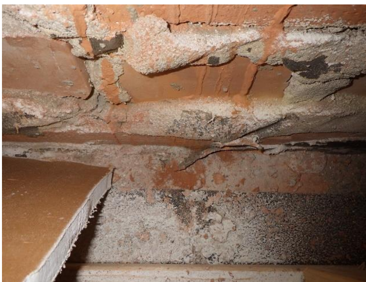
Kuva 186. Puretun kuorimuurauksen takana olevaa massiivitiiliseinää ei ole puhdistettu.
