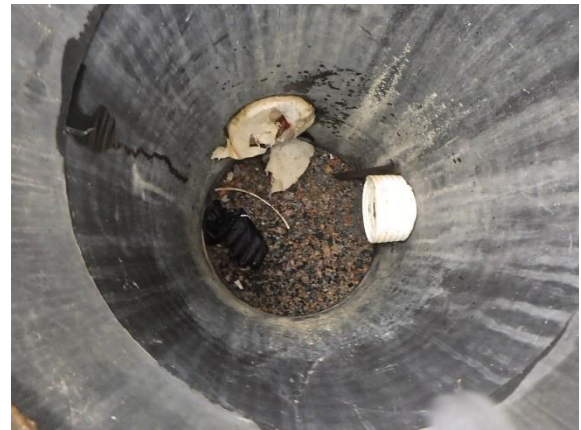
Kuva 6. Kuva tarkastuskaivosta numero 4. Vuosien 1991 ja 1998 laajennusosien salaojitusjärjestelmien liitoskohta.
