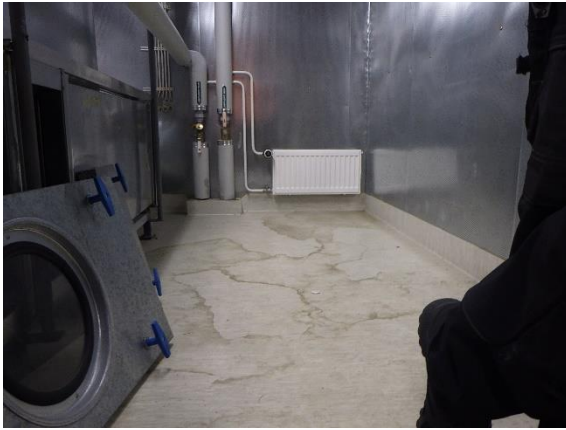
Kuva 279. Ilmanvaihtokonehuoneen lattialla on kuivuneita vesivuotojälkiä.
