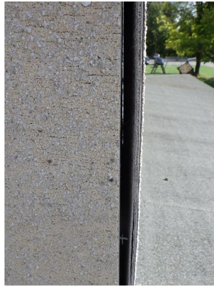
Kuva 128. Julkisivulevytyksen länsi-etelä-sivujen nurkkaus ei ole vesitiivis.
