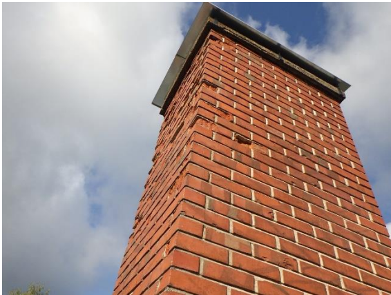
Kuva 71. Muuratussa savuhormissa on pakkasrapautumaa.
