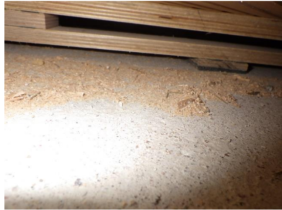
Kuva 48. Rakenneavaus RA-AP1. Maanvaraisen betonilaatan pinnalla on rakennusaikaista sahanpurua.
