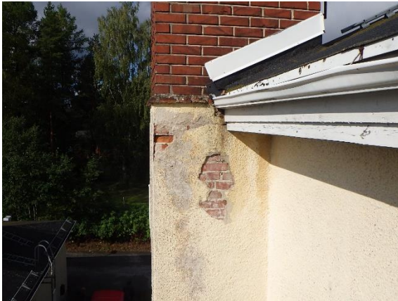
Kuva 247. Puutteellisen vedenohjauksen aiheuttama rappausvaurio savuhormin kyljessä.
