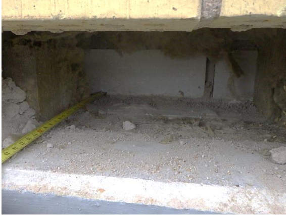
Kuva 91. Rakenneavaus RA-US14. Sokkelin ja ulkoseinän liitoksessa ei ole bitumikermiä, mikä toimisi rakenteessa kapillaarikatkona ja ohjaa julkisivun taakse pääsevää vettä ulospäin.
