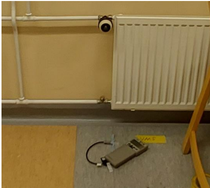
Kuva 29. Viiltomittaus VM5 huonetilassa 1031. Muovimaton alla suhteellinen kosteus (RH) = 45,8 %, lämpötila = 22,2 °C ja absoluuttinen kosteus = 9,0 g/m 3 .
