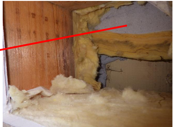
Kuva 140. Ulkoseinärakenteen US8 ikkunapellin kaato on tehty muurauslaastilla ja laasti täyttää kuorimuurauksen tuuletusvälin pellityksen kohdalta.
