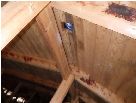
Kuva 265. Alipaineventtiilin kautta on päässyt sadevettä yläpohjatilaan.
