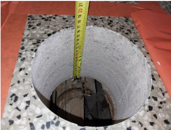
Kuva 13. Rakenneavaus RA-PO1. Itäisivun tuulikaapin portaiden alapuolella on tuulettumaton tyhjä tila.
