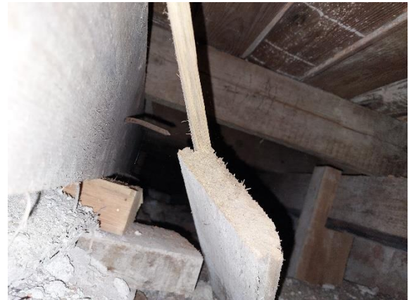
Kuva 14. Portaiden alla olevassa tyhjässä tilassa on rakennusaikaisia muottilaudoituksia ja portaiden alla on maapohja. Tilassa oli voimakas homeen haju.
