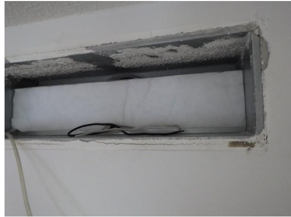
Kuva 285. Tuloilmapäätte-elimien äänieristeenä on polyesteriä (Dacron), josta ei irtoa mineraalikuituja sisäilmaan.
