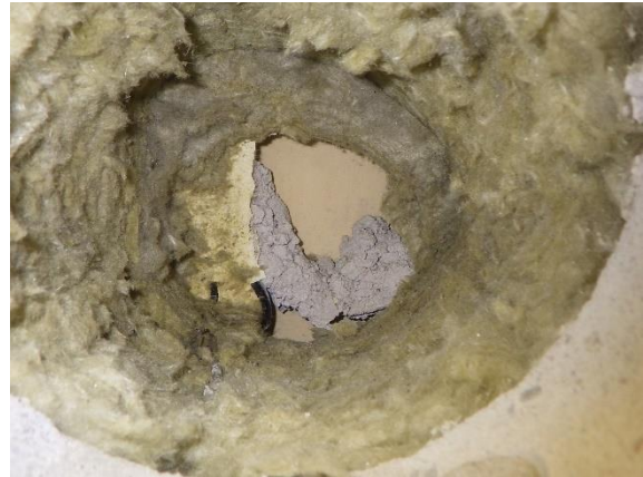
Kuva 97. Rakennusaukko RA-US12. Kuori- muurauksen takana olevassa tuuletusvä- lissä on muurauslaastipurseita.
