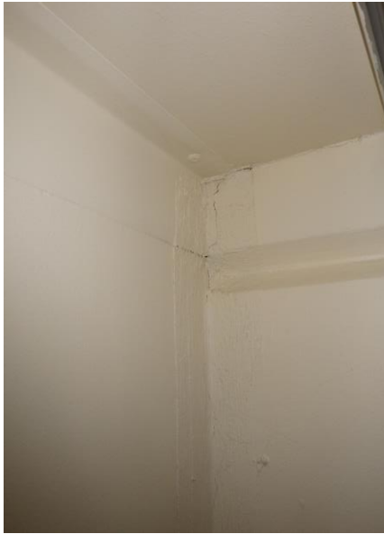
Kuva 106. Teräsbetonipilarin ja verhomuurauksen liitos on tiivistyskorjattu vedeneristeellä kiinnitettävällä vahvikenauhalla. Tiivistyskorjaus ei ulotu ulkoseinän yläosassa talotekniikkakotelon sisäpuolelle.
