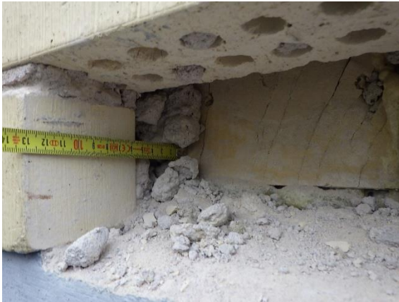
Kuva 96. Rakennusaukko RA-US1. Kuori- muurauksen takana olevassa tuuletusvä- lissä on muurauslaastipurseita.
