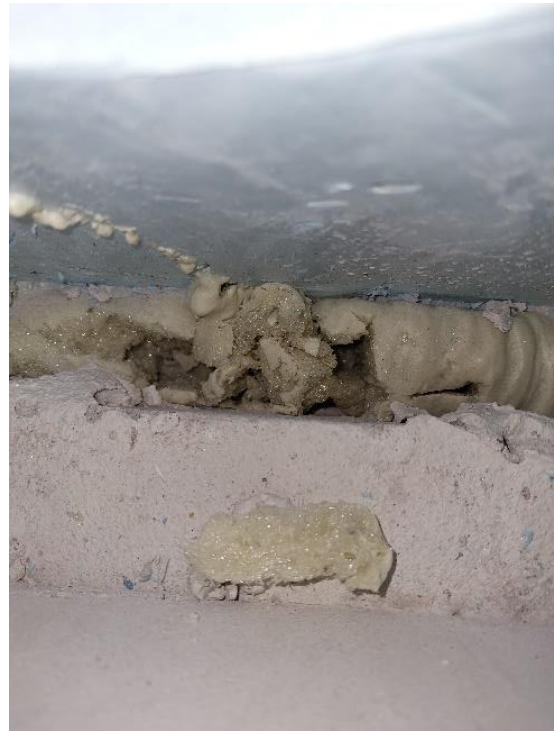
Kuva 79. Sokkelin yläpinnassa ei ole rakenneavauksen RA-US2 perusteella korjaussuunnitelmissa esitettyä vahvikenauhallaa ja vedeneristeellä tehtyä tiivistyskorjausta.
