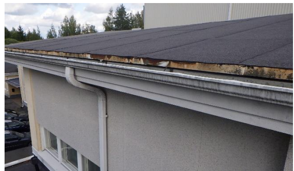
Kuva 250. Liikuntasalin räystäspellityksissä on laajalti ruosteaurioita.
