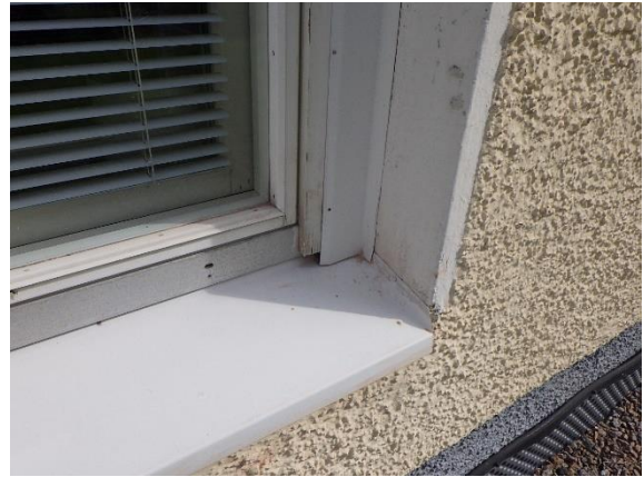
Kuva 150. Ikkunoiden puupuitteissa on huoltomaalauksen tarvetta lähitulevaisuudessa. Kuva 1950-luvun rakennuksen osa.
