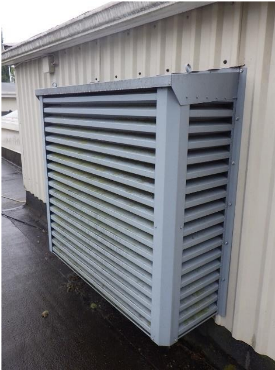
Kuva 281. Tuloilmakoneen TK3 ulkoilmasäleikössä on lumiloukku.
