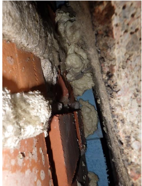
Kuva 81. Rakenneavauksen RA-US13 perusteella sokkelihalkaisun päällä ei ole korjaussuunnitelmissa esitettyä vedeneristeellä ja vahvikenauhalla tehtyä tiivistyskorjausta.
