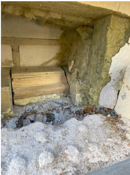
Kuva 98. Rakennusaukko RA- US18. Ikkunan alapuolella on ulkoseinärakenteessa puu- rankarunkoa. Alasidepuun alla ei ole bitumikermiä.
