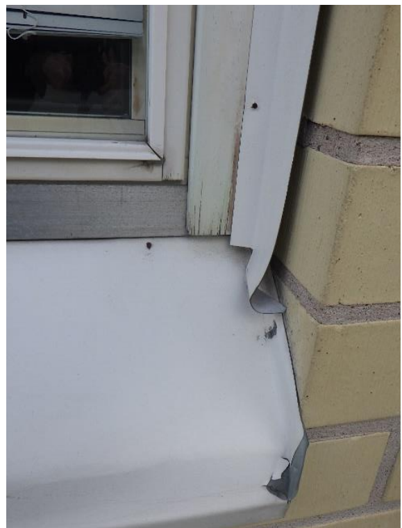
Kuva 152. Ikkunapellitustuksissa on paikallisesti vesivuotokohtia. Puupuitteissa ja peitelistoissa on huoltomaalauksen tarvetta lähitulevaisuudessa.
