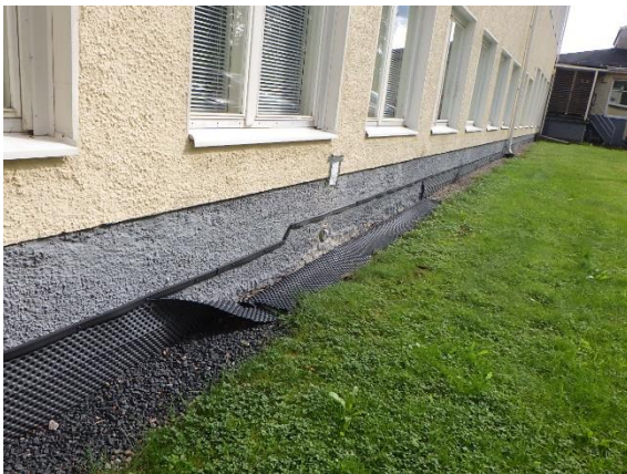
Kuva 74. Perusmuurilevy on rikkoutunut maanpinnan yläpuolelta. Kuva rakennuksen länsisivulta.
