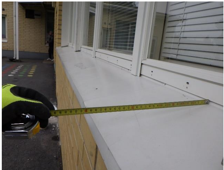
Kuva 155. Ikkunapeltien kaadot ovat riittäviä vuoden 1998 laajennusosassa.
