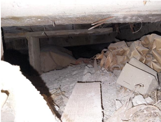
Kuva 161. Rakenneavaus RA-VP2. Alalaattapalkiston ontelotilassa on rakennusjätettä sekä rakennusvaiheen muottilaudat.
