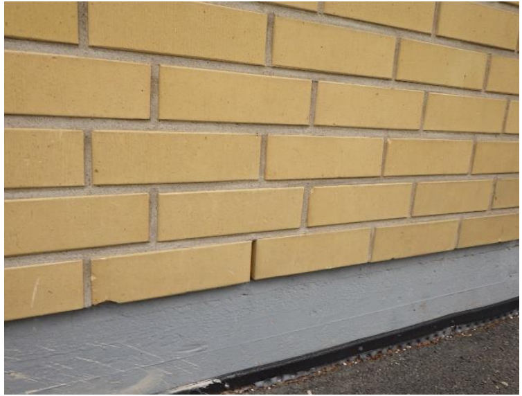
Kuva 138. Ulkoseinän US8 kuorimuurauksen alalaidan joka kolmas pystysauma on avoin vedenpoisto- ja tuuletusaukko.
