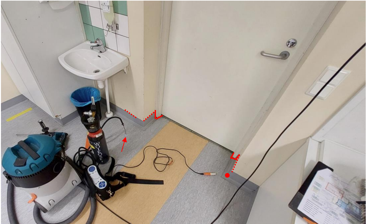
Kuva 31. Merkkiaineekoe MAK2 luokkatilassa 1007. Ilmavuotokohtat merkitty kuvaan punaisella. Yhtenäinen viiva = merkittävä ilmavuoto, katkoviiva = vähäinen ilmavuoto, pallo = pistemäinen ilmavuoto.
