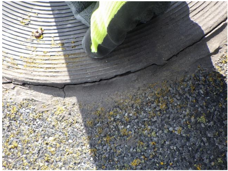
Kuva 264. Jälkiasenteisen alipaineventtiilin läpivientikappaleen tiivistysmassa on haurastunut ja halkeillut kauttaaltaan.
