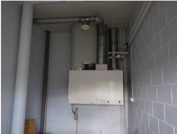
Kuva 288. Vuoden 1998 laajennusosaa palveleva tulo- ja poistoilmanvaihtokoneisto TK7/PK7.
