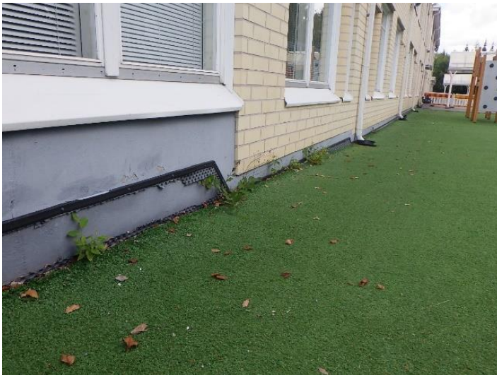
Kuva 90. Perusmuurilevy on rikkoutunut maanpinnan yläpuolelta rakennuksen itäisivulla.
