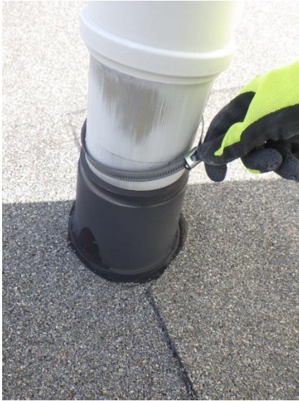
Kuva 267. Viemärin tuuletusputken kiristyspanta on irronnut.
