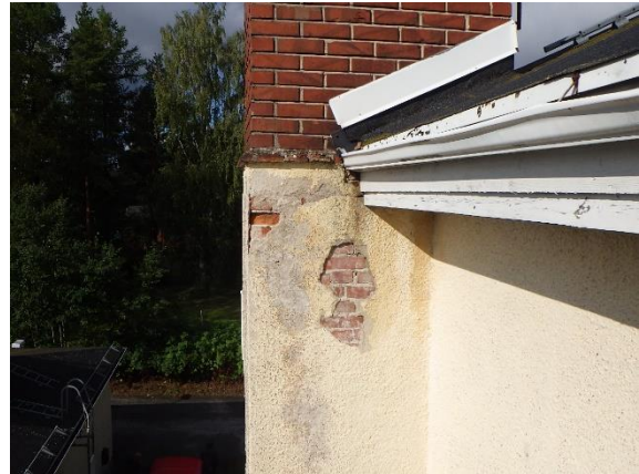
Kuva 70. Kaksikerroksisen osan itäisivulla räystäskourujen ylitse tulleet kattovedet ovat aiheuttaneet savuhormin rappauksen rapautumisen ja irtoamisen.
