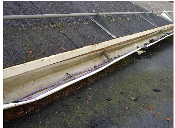
Kuva 246. Räystäskourun kiinnikkeet ovat paikoin irronneet.
