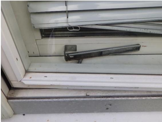
Kuva 153. 1990-luvun rakennuksen osassa tuuletusikkunoiden sulkumekanismi on rikkoutunut ja tuuletusikkunoita on auki / raollaan.
