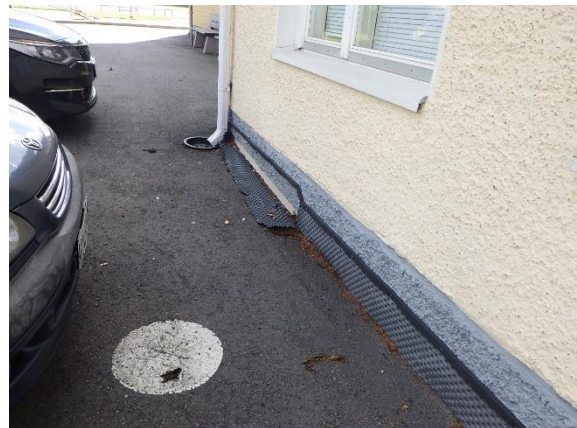
Kuva 75. Perusmuurilevy on rikkoutunut maanpinnan yläpuolelta rakennuksen itäisivulta.
