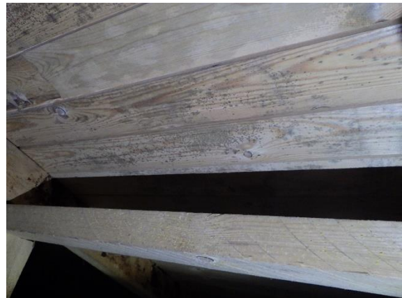
Kuva 217. Paikallista mikrobikasvustoa vesikaton ponttilaudoituksessa.
