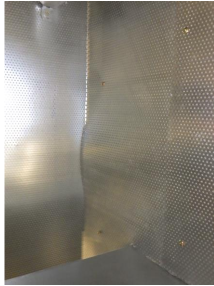
Kuva 277. Tuloilmakoneiston TK1 ilmanjakokammion sisäpintana on reikäpeltiä, jonka takana on pinnoitettua mineraalivillaa. Havaintojen perusteella pinnoite oli ehjä.
