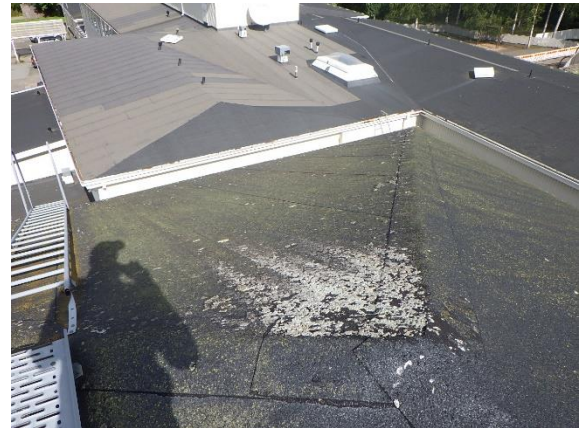
Kuva 234. Jäkäläkasvustoa vesikatteen pinnalla.
