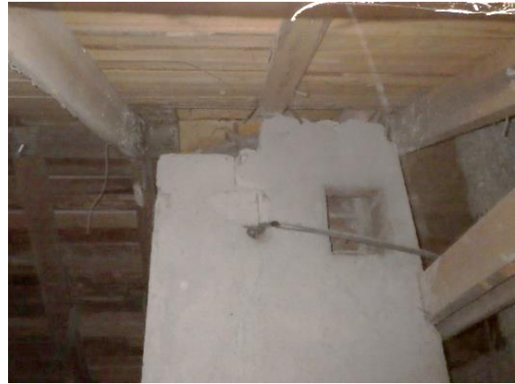
Kuva 199. Käytöstä poistettu savuhormi ullakkotilassa. Hormi on katkaistu vesikatteen alapuolelle.
