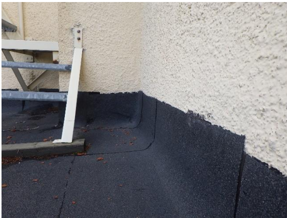
Kuva 241. Bitumikermin ylösnostoa ei ole suojattu pellityksellä.
