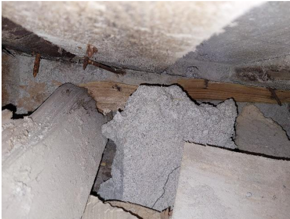
Kuva 160. Kuva rakenneavauksesta RA-VP2. Alalaattapalkiston ontelotilassa on rakennusjätettä sekä alkuperäiset muottilaudat.
