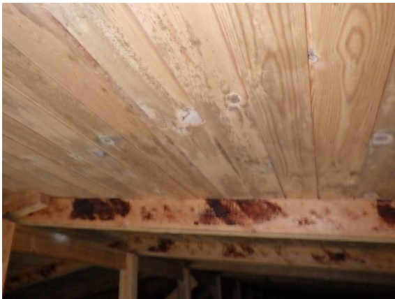
Kuva 216. Paikallista mikrobikasvustoa vesikaton ponttilaudoituksessa.
