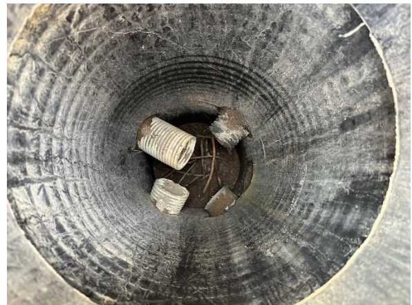
Kuva 14. Rakennuksen salaojitus on osittain uusittu (harmaat putket) ja osittain vanhempaa (valkoiset putket). Valokuva on otettu pohjois- ja itäjulkisivun nurkasta.
