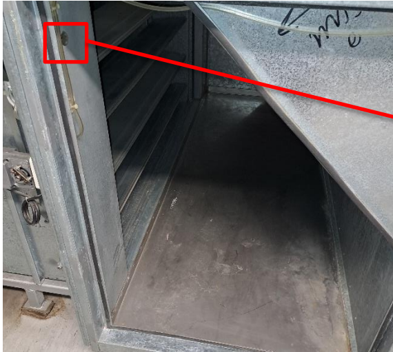
Kuva 106. Poistoilmapielit eivät sulkeutuneet huoltokytkimestä.
