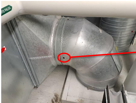
Kuva 130. Tulokanava TK6.1 konehuoneessa.
