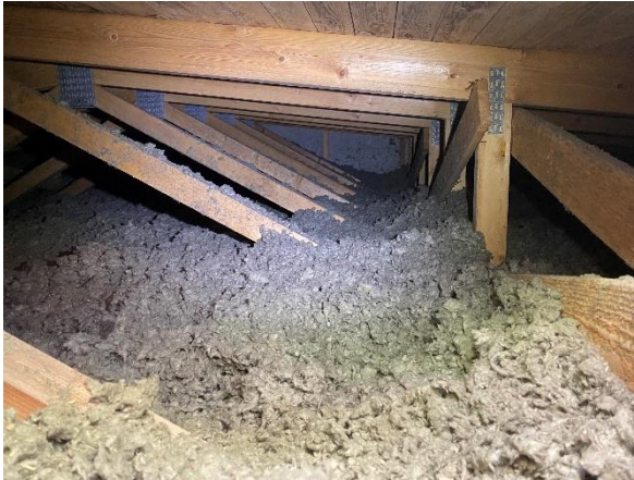
Kuva 94. Yleiskuva puurakenteisesta yläpohjatilasta. Vesikatteen aluslaudoituksessa on yläpohjan heikkoon tuulettumiseen viittaavia jälkiä.
