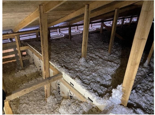
Kuva 91. Yläpohjatila alkuperäisen osan ja laajennusosan liitoksesta. Laajennusosalla rakenteen yläpinta on korkeammalla kuin alkuperäisen osalla.
