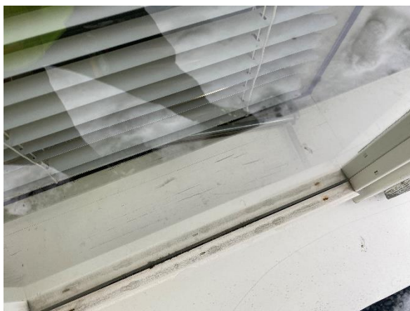
Kuva 61. Ensimmäisen kerroksen ikkuna länsijulkisivulla. Sisäpuolisissa puuosissa havaittiin paikallisia halkeamia.
