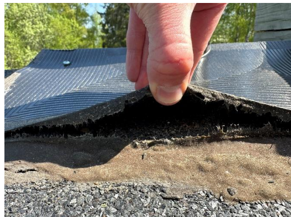
Kuva 83. Läpivientien liitokset eivät ole tiiviitä.
