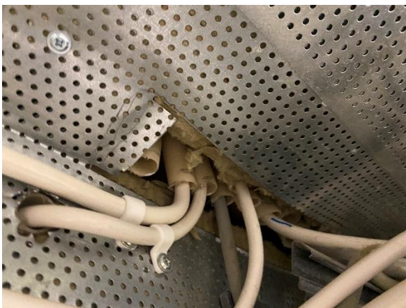
Kuva 96. Avoin läpivienti IV-konehuoneen 2118 katossa.
