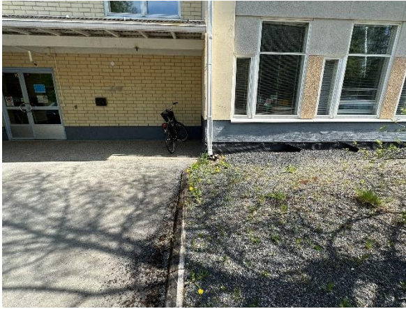
Kuva 7. Myös pohjoissivulla rakennuksen vierustat on sisäänkäyntien kohdalla jätetty korjaamatta.
