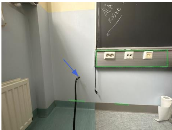
Kuva 78. Merkkiainekoe VS 1. Merkkiainekokeessa havaittiin vähäistä ilmavuotoa sähkökaapelikourun kiinnikkeiden kohdilta sekä välipohjan ja väliseinän liitoksesta.
