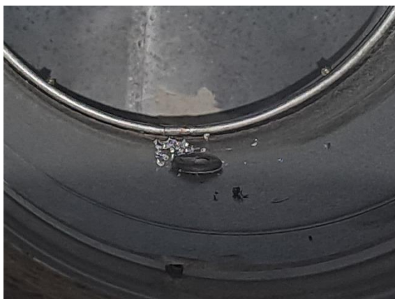
Kuva 126. Peltijäysteitä kanavaan tehdyssä reiässä.
