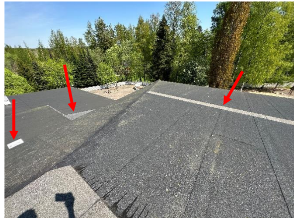
Kuva 81. Vesikatetta on paikkailtu yksittäisiltä kohdilta.
