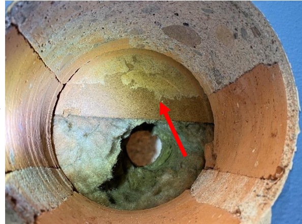
Kuva 33. Rakenneavaus US-5 ikkunan alapuolelle. Ulkoseinän ja ikkunan liitoksessa on erillinen puukuitulevy, jonka pinnassa havaittiin kosteusjälkiä (punainen nuoli).
