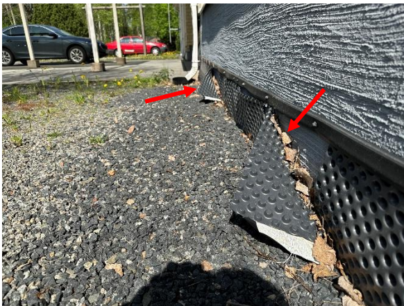
Kuva 13. Perusmuurilevytys on yksittäisten saumojen kohdilla auennut kiinnityslistan alta.
