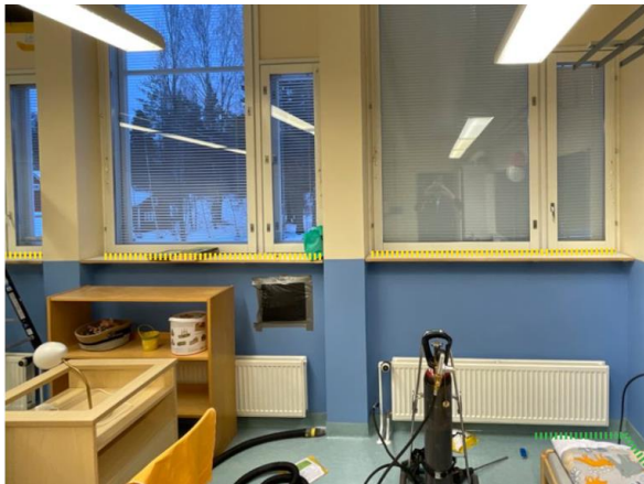
Kuva 38. Merkkiainekoe US 4. Merkkiainekokeessa havaittiin vähäistä ilmavuotoa ulkoseinän ja ikkunan liitoksesta sekä pistemäistä ilmavuotoa ulkoseinän ja välipohjan liitoksesta tilan nurkka-alueella.
