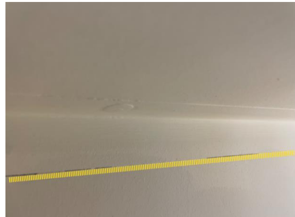
Kuva 54. Merkkiainekoe US 2. Lähikuvaa ulkoseinän yläosan ja välipohjan liitoksesta, josta havaittiin vähäistä ilmapuotoa metallisen listan takaa. Liitosta ei ole tiivistyskorjattu.
