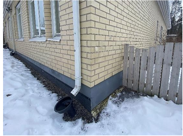
Kuva 8. Pohjois- ja itäjulkisivujen ulkonurkka. Pohjoispäädyn ulkopuoliset rakenteet ovat vanhempia kuin muualla. Nurkassa suppilokaivo on kääntynyt siten, että kattovesiä ohjautuu osittain myös sokkelin vierustalle.
