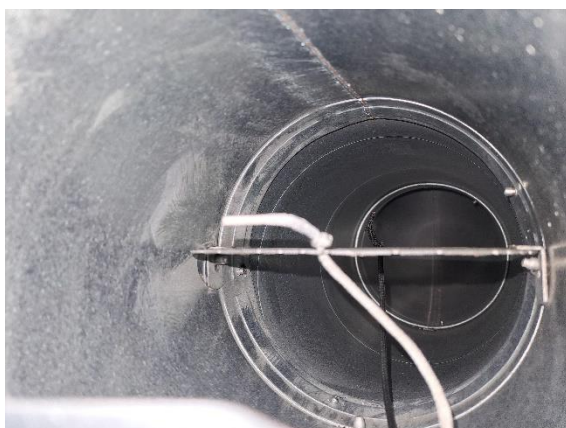
Kuva 128. Näkymä tulokanavaan luokassa 2028, kanavassa on paikoittain pölyä.
