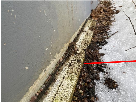
Kuva 9. Rakennuksen pohjoispäädystä sokkelin vedeneristeenä on vanha bitumikermi eikä liitoksessa ole muiden julkisivujen tavoin perusmuurilevytystä. Bitumikermin liitos betonirakenteeseen ei ole tiivis.
