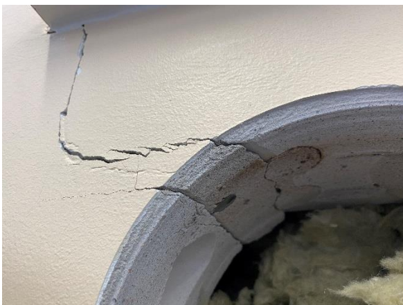
Kuva 51. Rakenneavaus RA-US 12. Ikkunan alapuolen halkeama ulottuu koko tiilimuurauksen läpi.
