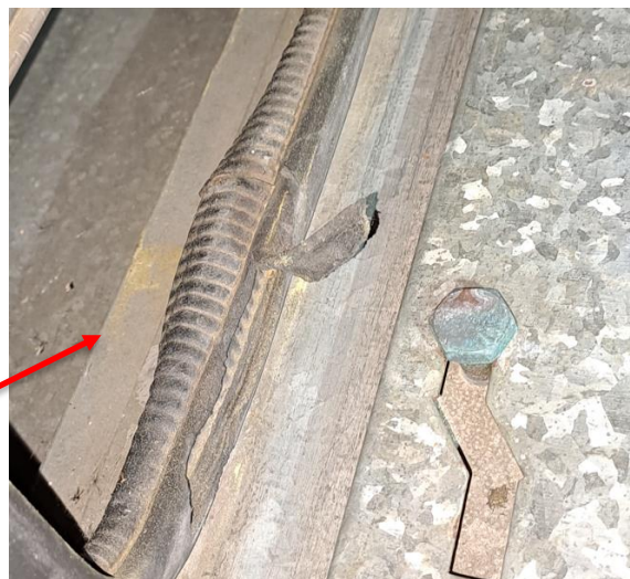
Kuva 103. Raitisilmasuodattimen kehyksen tiivisteet ovat osin rikkoontuneet.
