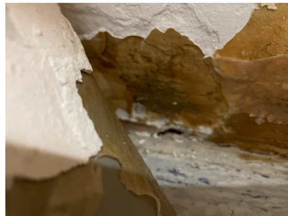
Kuva 23. Lähikuva merkkiainekokeen AP 3 kohdalta. Alapohja ja porrashuoneen väliseinän liitoksessa on rako. Jäykistävän väliseinän ja alapohjan liitosta ei ole tiivistyskorjattu.
