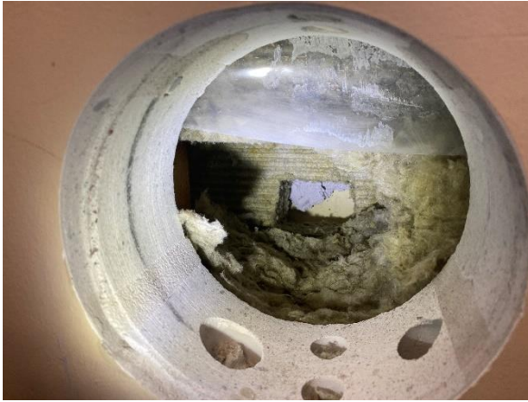
Kuva 41. Rakenneavaus RA-US 8. Laajennusosalla ulkoseinien sisäkuori on pääosin kalkkihiekkatiiltä. Ikkunan ja ulkoseinän liitoksessa on höyrynsulkumuovi.
