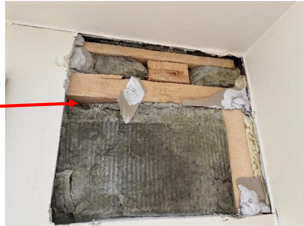
Kuva 35. Rakenneavaus RA-US 6 ikkunauharakenteeseen. Seinärakenne on toteutettu ilman höyrynsulkua.
