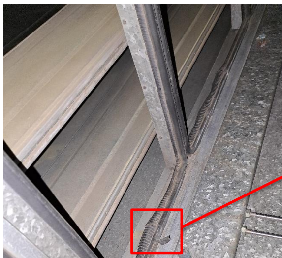
Kuva 102. Raitisilmapeltilä ei sulkeutunut huol- tokytimestä.
