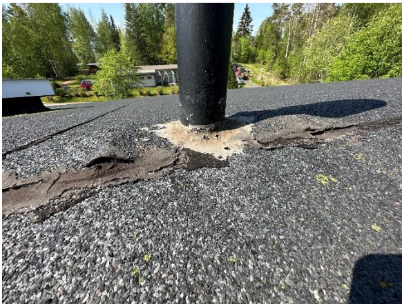
Kuva 84. Läpivientejä on paikkailtu erinäisillä massoilla, mutta paikkaukset ovat monin paikoin repeilleet ja haurastuneet.
