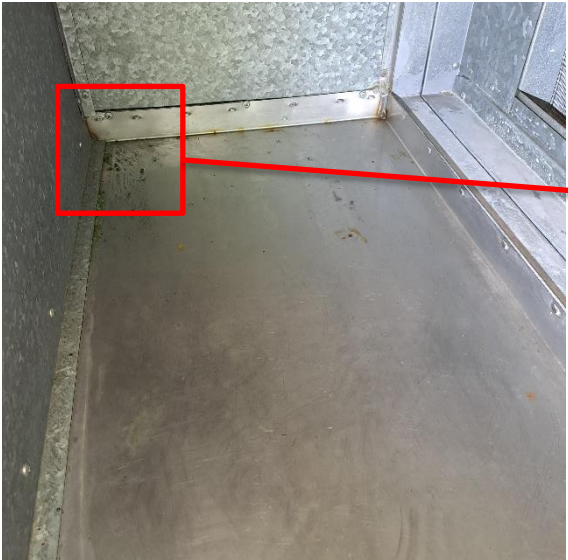
Kuva 118. Tulokoneen LTO-kammio ennen lämmityspatteria.
