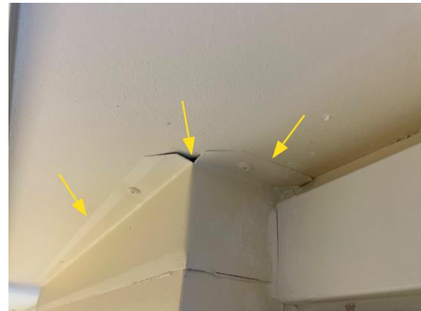
Kuva 56. Merkkiainekoe US 3. Merkkiainekokeessa havaittiin vähäistä ilmapuotoa ulkoseinän yläosassa olevan tekniikkakotelon liitoksesta.
