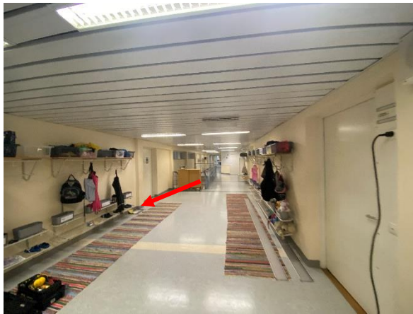
Kuva 68. Käytävän rakenneevauksen RA-VP 5 kohdalla oleva musta liima sisältää asbestia (punainen nuoli).
