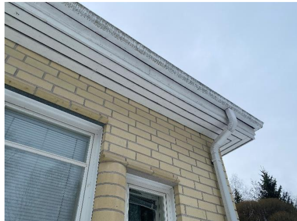
Kuva 85. Yläpohjatila tuulettuu leveän räystäärakenteen kautta. Räystäät on toteutettu ilman pieneläinverkkoja.
