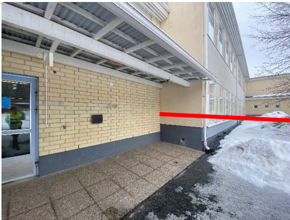
Kuva 49. Porrashuoneen jäykistävän ulkoseinän (US-6), päätyseinän (US-4) ja liittyvän väliseinän (VS-1) liitoksesta on rako.
