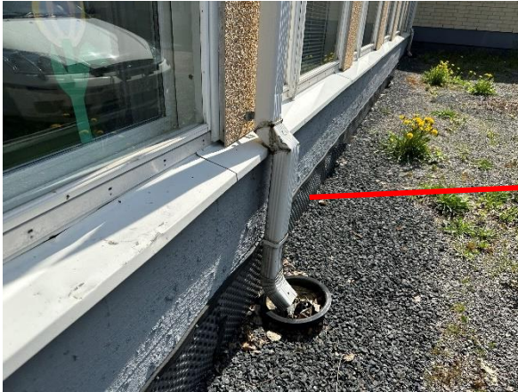
Kuva 11. Länsisivulla yksittäisen syöksytorven liitososat vuotavat siten, että vettä pääsee ohjautumaan ikkunan vesipellitykselle sekä sokkelin ulkopinnalle.
