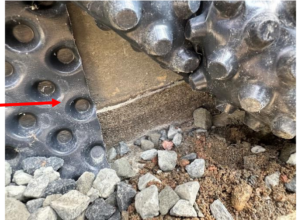
Kuva 12. Uusitulla alueella sokkelin ulkopinnassa on kermi, joka jatkuu maanpinnan alapuolella. Sokkelin ulkopintaan on asennettu perusmuurilevytys maanpinnan ja sokkelin liitokseen. Maa-aines on pintaosissa karkeajakoista, mutta syvemmällä hienojakoista.
