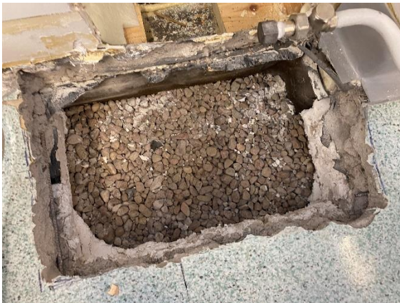
Kuva 16. Rakenneavaus AP-3 alkuperäiseen osaan ulkoseinälinjalle. Alkuperäisen osan alapohja on uusittu maatayttyä myöten vuonna 2005. Samassa yhteydessä alapohjaliitokset on tiivistyskorjattu.
