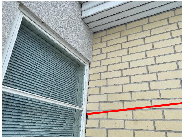
Kuva 36. Opetustilan 1048 ja liikuntavälinevaraston 1142 ulkoseinien liitoksessa on laaja-alainen rako.
