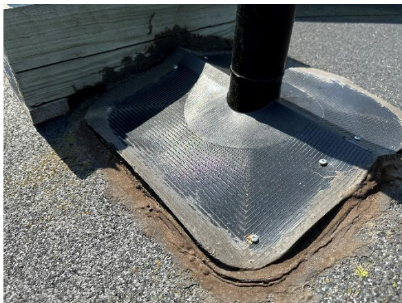
Kuva 82. Vesikaton läpivientejä on myöhemmin uusittu ja ne on asennettu bitumikermikatteen päälle.
