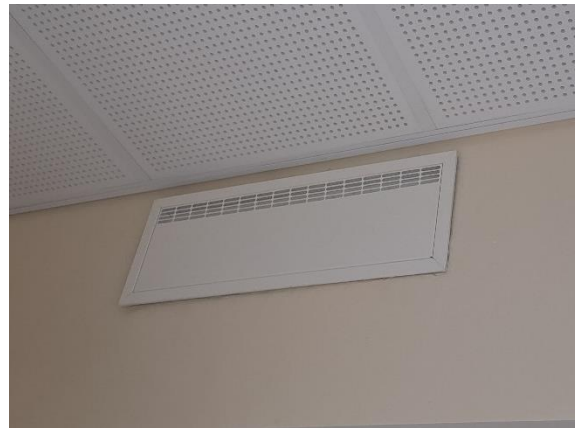
Kuva 137. Yleiskuva tuloilman [Lapinleimu SVB] päätelaitteesta.
