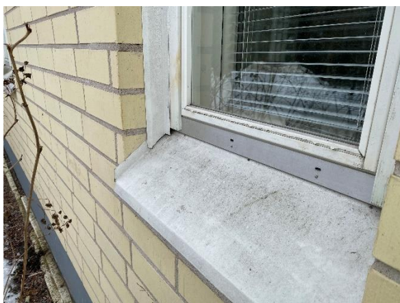
Kuva 63. Ikkuna itäjulkisivulla. Vesipellitukset ovat likaantuneet, mutta rakenteellisesti hyväkuntoiset. Vesipellitusten ulottuma seinälle on vähäinen.
