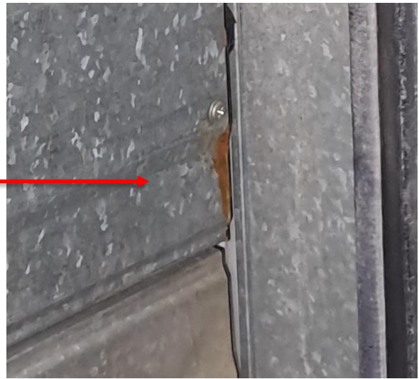
Kuva 117. Lamellissa on pintakorroosiota.
