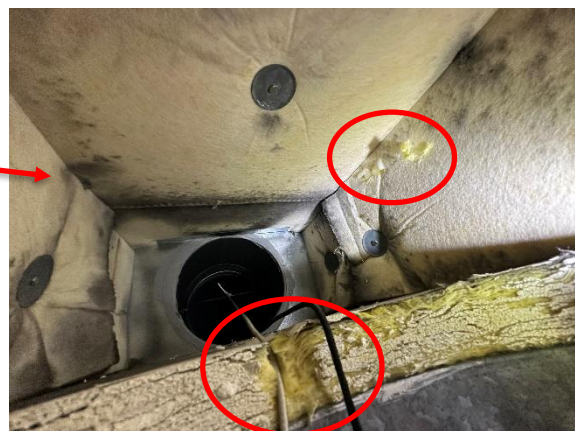
Kuva 139. Villaeriste on paikoittain vahingoittunut.
