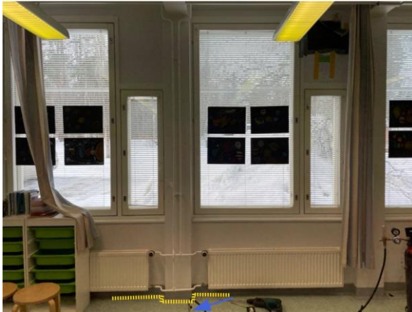
Kuva 20. Merkkiainekoe AP 1. Merkkiainekokeessa havaittiin vähäistä ilmavuotoa alapohjan ja ulkoseinän liitoksesta sekä pistemäistä ilmavuotoa vinyylilaattojen reuna-alueilta läheltä ulkoseinäliitosta.
