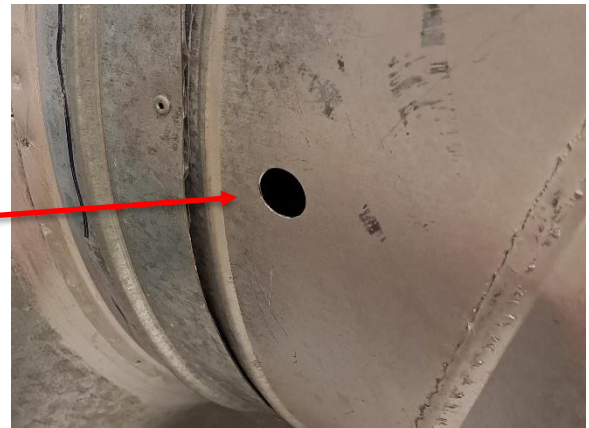
Kuva 131. Kanavistossa havaittiin tulppaamattomia mittausreikiä.
