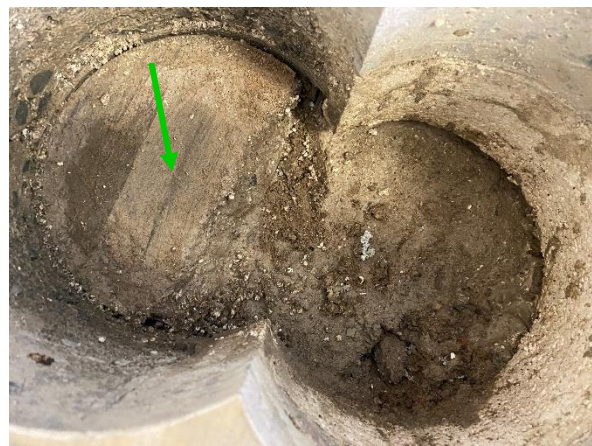
Kuva 19. Rakenneavaus RA-AP 4. Vanhan ulkoseinän sokkelin ja betonivalun välissä ei havaittu suunnitelmassa esitettyä XPS-eristekatkaisua. Lisäksi liitoksessa olevaa tiivistyskäsittelyä on asennettu betonivalukaistan alapuolelle, eikä valun yläpintaan. Tiivistyskäsittelyä ei myöskään ole ulotettu alapohjalaatalle. Tiivistyskäsittelyn sijainti osoitettu vihreällä nuolella.
