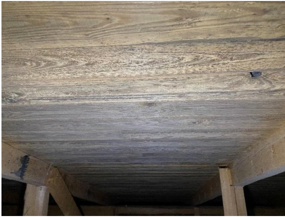
Kuva 92. Laajennusosan vesikatteen aluslaudoitus on alkuperäinen ja siinä on havaittavissa erityisesti keski-alueella jälkiä, jotka viittaavat yläpohjatilan heikkoon tuulettuvuuteen.
