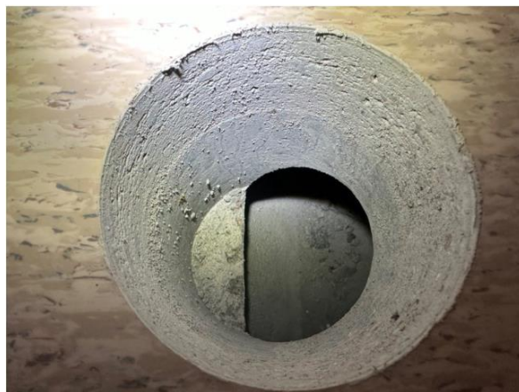
Kuva 67. Rakenneavaus VP-3 laajennusosaan. Välipohja on ontelolaattarakenteinen. Alapinnassa on vaihdellen maali ja akustiikkalevytys.
