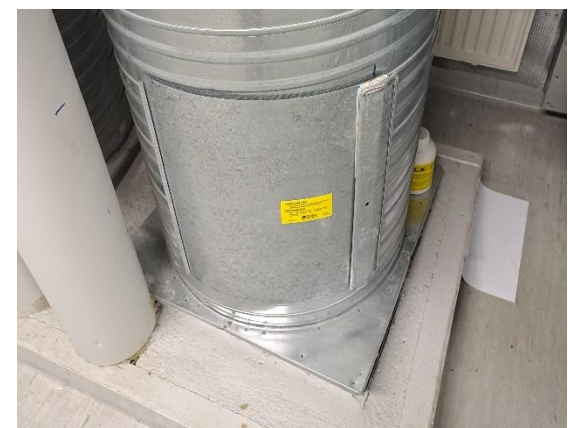
Kuva 135. Kanavan läpiviennissä on palokatkomassa.
