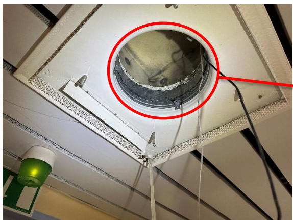
Kuva 138. Käytävän tuloilmapäätelaite, jossa äänenvaimentimena mineraalivillaa.
