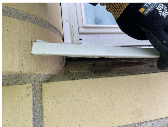
Kuva 64. Ikkunoiden vesipellitysten liitokset ovat kuorimuurattujen julkisivujen kohdilla epätiivitä.
