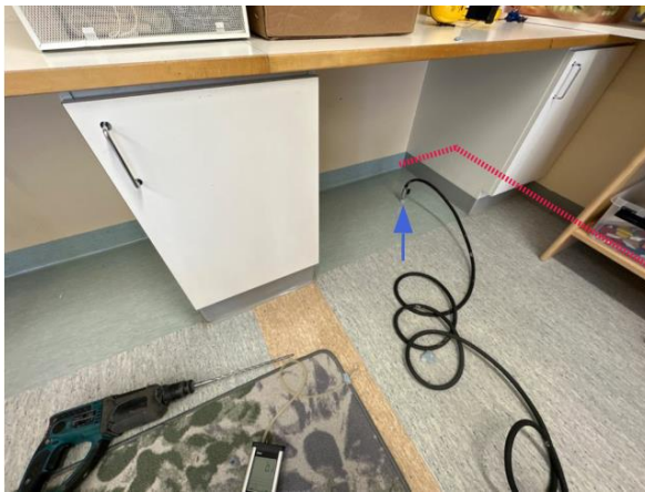
Kuva 22. Merkkiainekoe AP 3. Merkkiainekokeessa havaittiin merkittävää ilmavuotoa alapohjan ja porrashuoneen väliseinän liitoksesta. Liitoksessa aistinvaraisesti havaittavissa rako.
