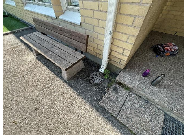
Kuva 4. Sadevedet ohjataan syöksytorvien avulla sadevesikaivoihin. Sadevesikaivoja havaittiin kaikkien syöksytorvien alapuolella, mutta osittain sadevesikaivot ovat valurautaisia, laakeita kaivoja suppilokaivojen sijasta.
