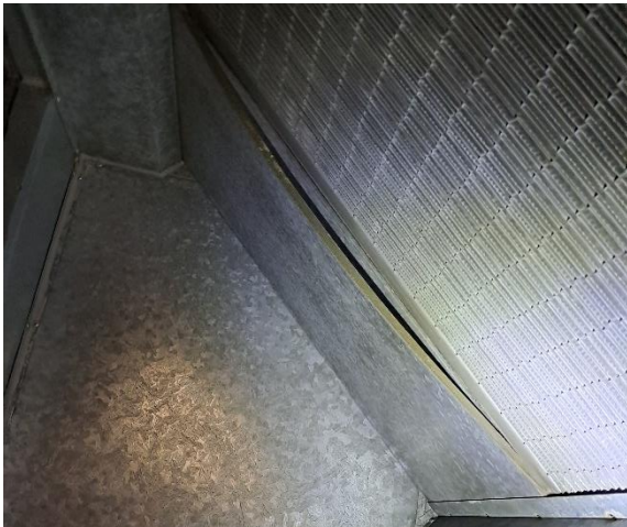
Kuva 108. LTO-kuution tiiviste on osin irronnut.
