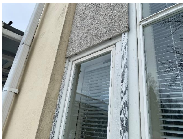
Kuva 62. Ensimmäisen kerroksen ikkuna länsijulkisivulla. Ikkunoiden ulkopuolisissa puuosissa havaittiin eriasteisia vaurioita erityisesti ikkunoiden nurkka-alueilla sekä ulkopuolisissa peitelistoissa.
