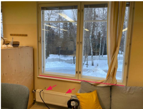
Kuva 55. Merkkiainekoe US 3. Merkkiainekokeessa havaitut merkittävät ilmapuodot on esitetty punaisella. Lisäksi merkkiainekokeessa havaittiin vähäistä ilmapuotoa ulkoseinän yläosassa olevan tekniikkakotelon liitoksesta, ks. viereinen kuva.
