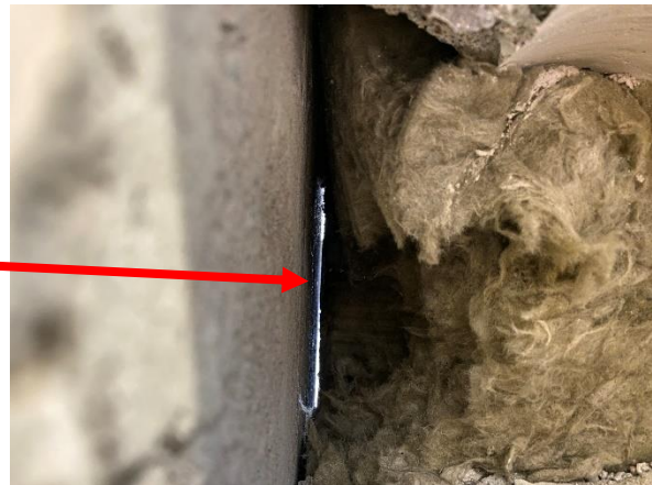
Kuva 50. Raosta havaittiin voimakasta ja merkittävää ilmavuotoa aistinvaraisesti sekä lämpökuvauksessa.
