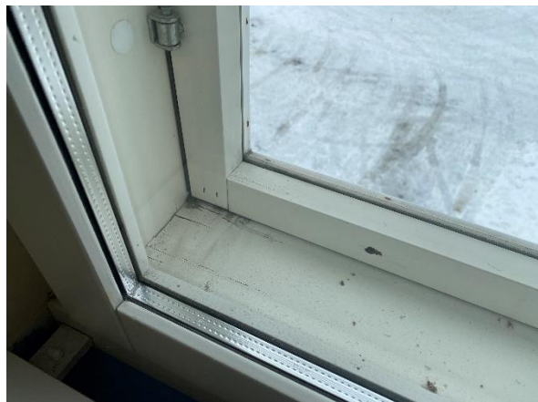
Kuva 60. Toisen kerroksen ikkuna länsijulkisivulla. Sisäpuolisissa puuosissa havaittiin halkeamia erityisesti ikkunoiden nurkka-alueilla.
