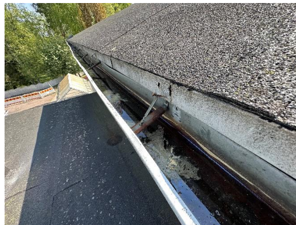
Kuva 87. Korkeamman osan eli porrashuoneen räystäärakenne. Tällä kohdalla ei ole sulanapitokaapeleita, minkä vuoksi räystäskouruun kerääntyy talviaikaan lunta ja jäätä. Lumen ja jään painosta sadevesikouru on vääntynyt.
