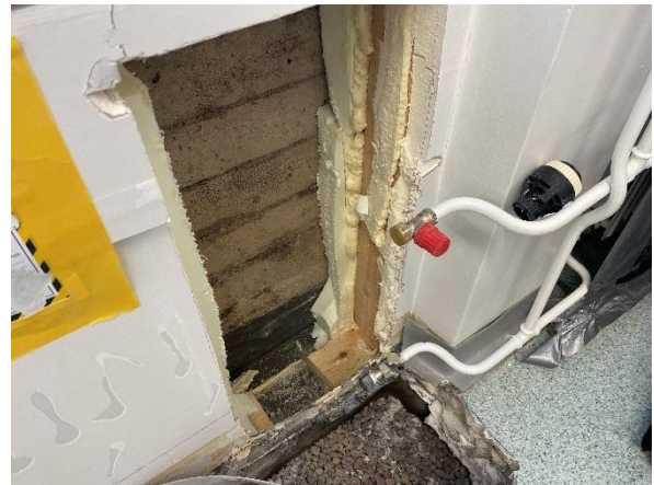
Kuva 29. Rakennevaus RA-US 8. Seinän alaosa on toteutettu muutossuunnitelmien mukaan ja liitos on tiivistyskorjattu.
