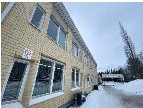
Kuva 39. Yleiskuva laajennusosan ulkoseinistä. Ulkoseinät on toteutettu julkisivuiltaan puhtaaksimuurattuina rakenteina. Ikkunoiden yläosat on toteutettu erillisillä muuratuilla ulokerakenteilla.
