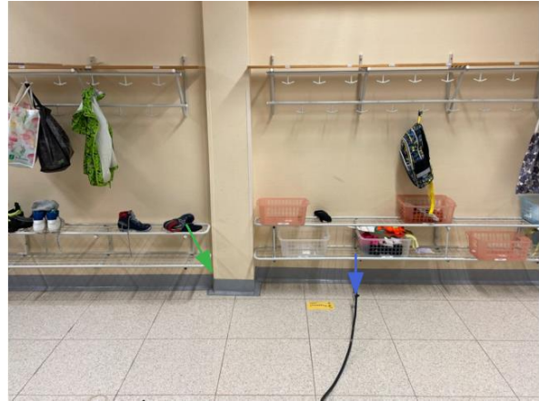
Kuva 21. Merkkiainekoe AP 2. Merkkiainekokeessa havaittiin pistemäistä ilmavuotoa alapohjan, pilarin ja kantavan väliseinän liitoksesta.
