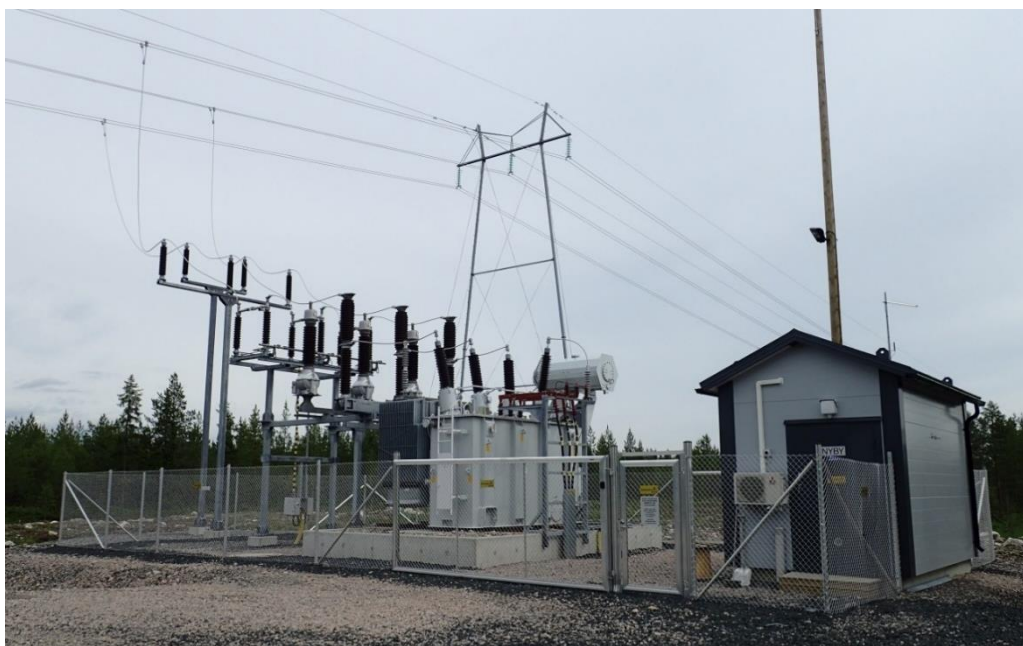
Kuva 9-7. Esimerkki tuulivoimahankkeen sähköasemasta (Minna Takalo, FCG).
