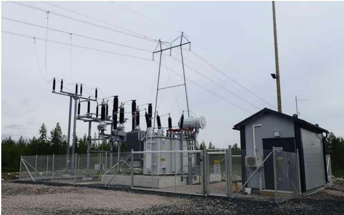
Kuva 4.11 Esimerkki tuulivoima-alueen sähköasemasta (FCG Rakennettu ympäristö Oy).
