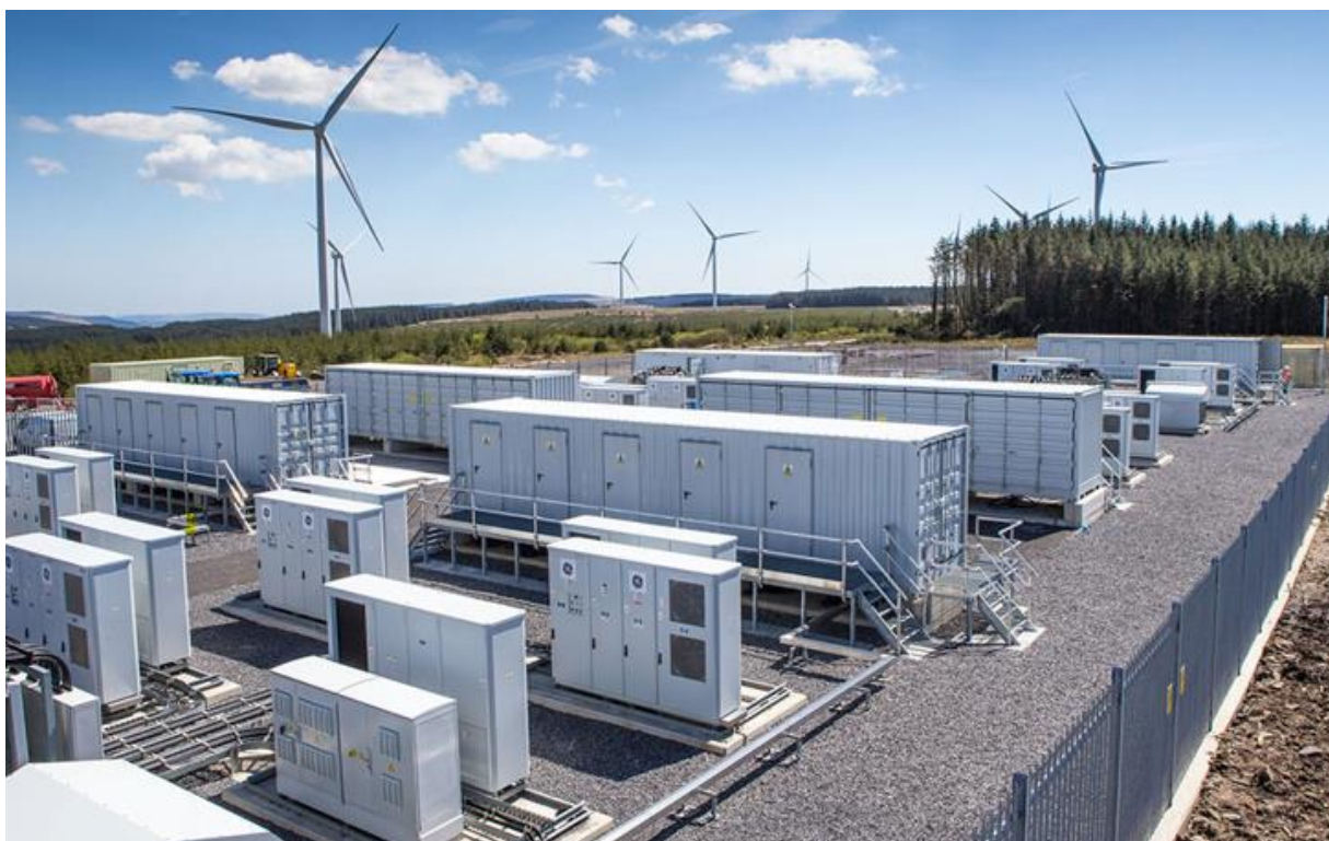
Kuva 5. Mallikuva akkuenergiavarastosta. Kuva: Vattenfall.
