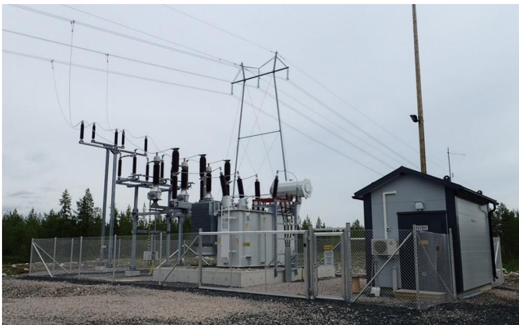
Kuva 9.7. Esimerkki tuulivoimahankkeen sähköasemasta (Minna Takalo, FCG).
