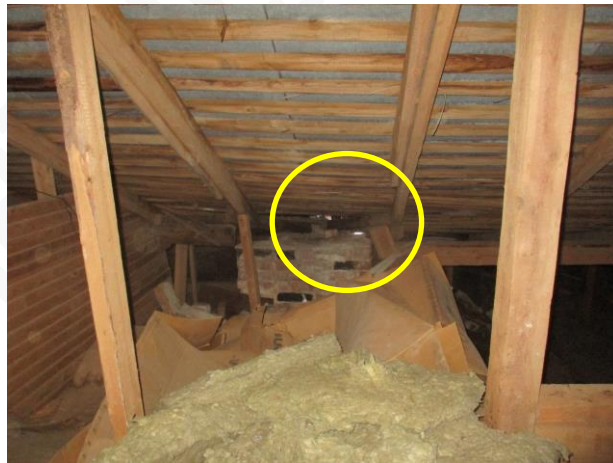
Kuva 4h. Reikä vesikatteessa.
