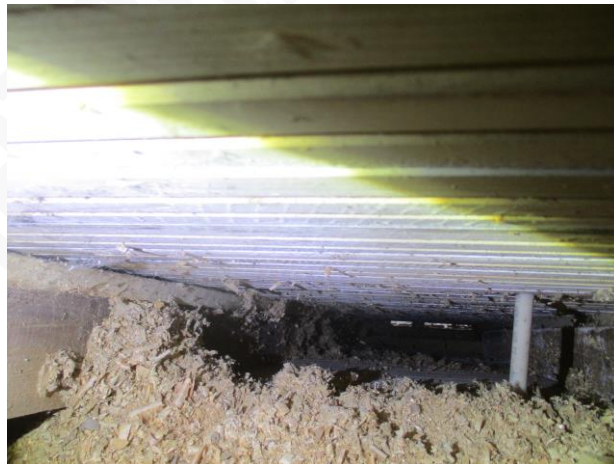
Kuva 2c. Rakennuksen päätyjä ei ole eristetty.
