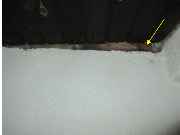
Kuva 12c. Hormirakenteen ja kattorakenteen saumassa rako, joka viittaa tulisijan perustusten vajoamiseen.
