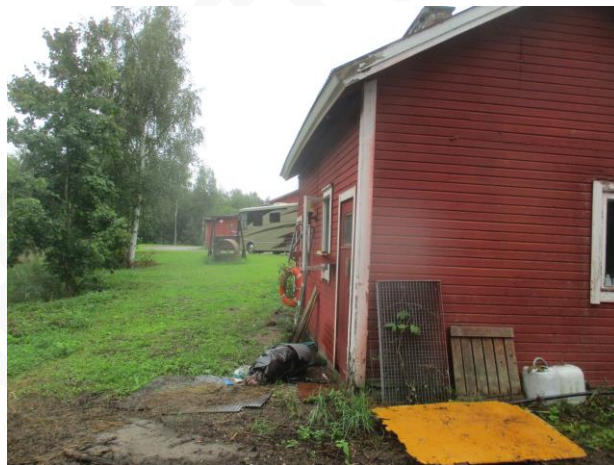
Kuva 1a. Kattovedet ohjautuvat rakennuksen vierustalle.
