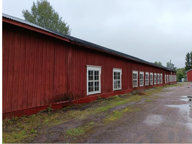
Kuva 2e. Yleiskuvaa verhouksesta. Kosteusjälkiä verhouksen alaosissa.
