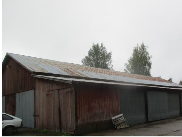
Kuva 4a. Katteessa on korroosiota laajalla alueella.
