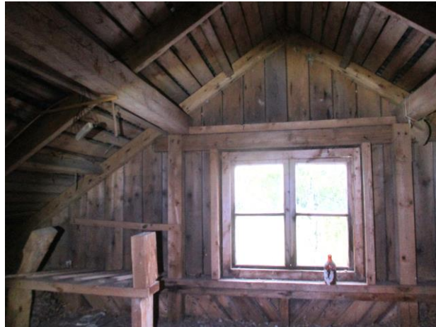
Kuva 4d. Päätylaudoitusta. Päätytuuletusventiiliä ei ole asennettu.
