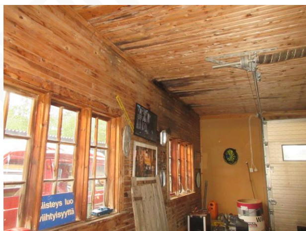
Kuva 4e. Akuutti kosteusvauriokohta, joka ulottuu myös seinärakenteeseen.
