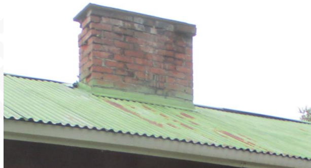
Kuva 12b. Hormissa rapautumaa ulkopuolella. Piippua ei ole pellitetty eikä piipun päällä ole sadehattua.
