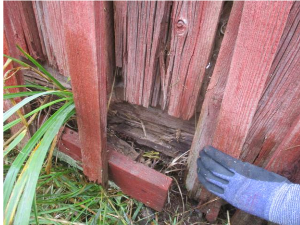
Kuva 1b. Lahovaurio rungon alaosassa.
