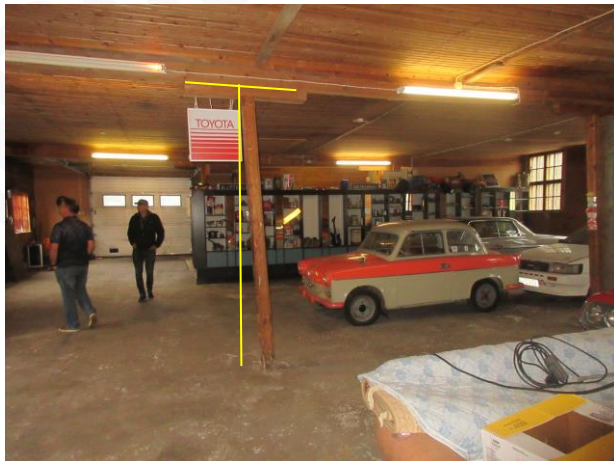
Kuva 1d. Pilarin nurjhdustarkastelunkin perusteella rakennuksessa on kokonaiskallistuma. Kantavat rakenteet ovat siis kallistuneet joen puoleiselle sivulle.
