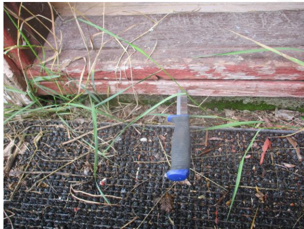
Kuva 2b. Myös ovien kynnyksissä oli havaittavissa lahoa.
