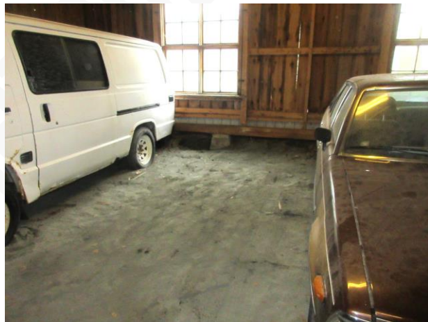
Kuva 2g. Viistosade on tunkeutunut lomarimalaudoituksen raoista sisäpuolelle.
