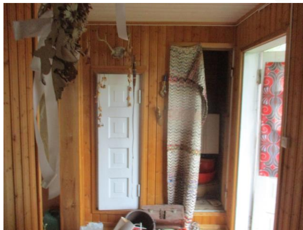
Kuva 6c. Eteistilaa. Ullakkoportaikon ovi puuttuu.
