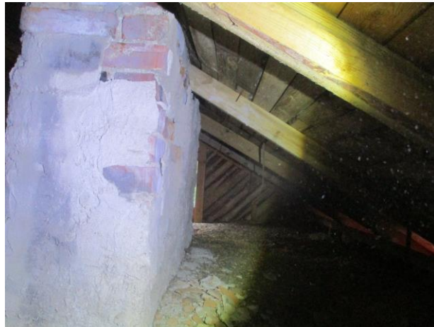
Kuva 4c. Hormissa oli havaittavissa rappauksen irtoamista sekä kosteusjälkiä.
