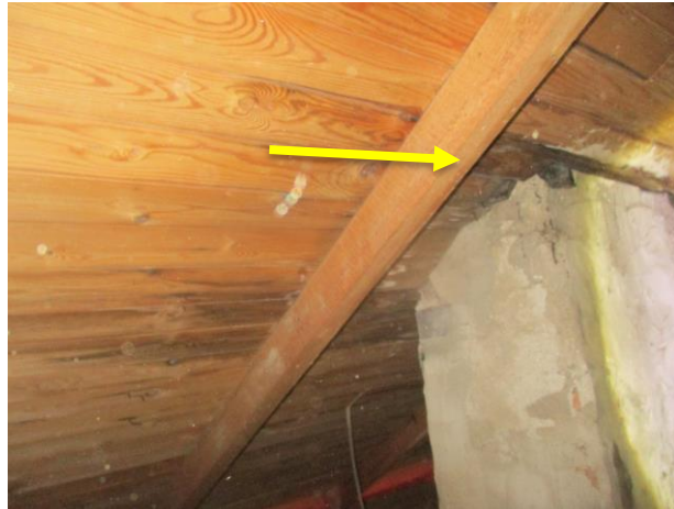
Kuva 4b. Yläpohjassa oli havaittavissa kosteusjälkiä. Kyseessä on piipun läpiviennin juurivuoto.
