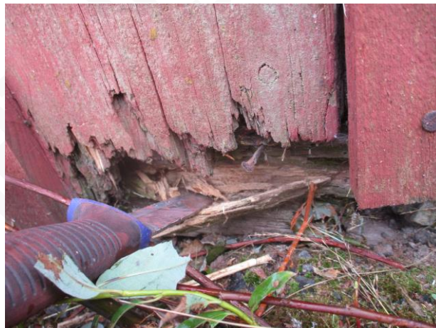
Kuva 1j. Rungon alaosissa todettiin lahoa.
