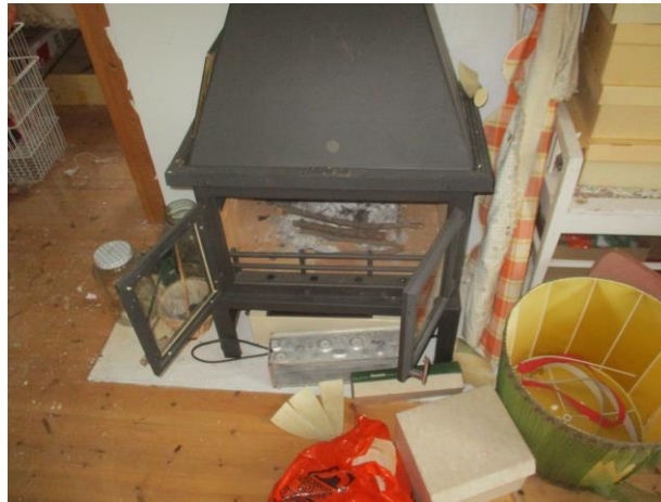
Kuva 12b. Kipinäsuojaus on takan edustalle asettamatta.
