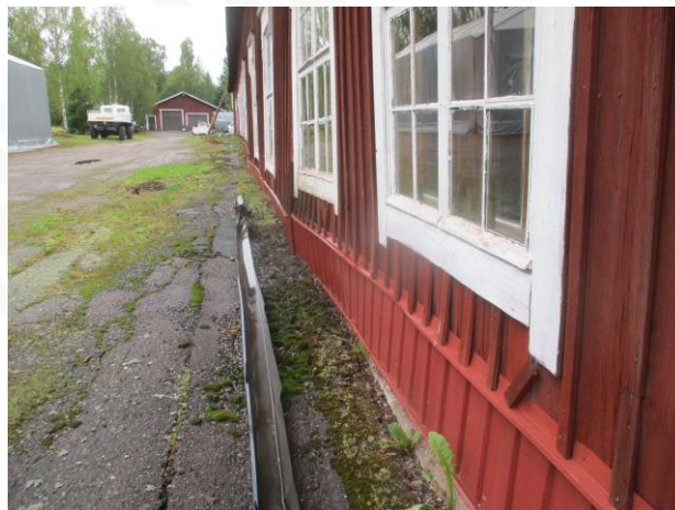
Kuva 1a. Rakennuksen vierustaa. Asfaltti on halkeillut, ehkä routimisen vuoksi. Kattovedet ohjautuvat sokkelin vierustalle. Muodon muutokset runkorakenteessa havaittavissa.
