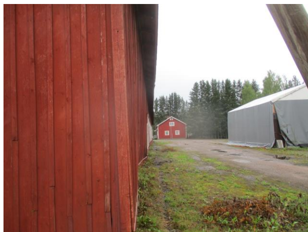
Kuva 1e. Muodon muutos todettavissa niin runko- rakenteessa, kuin sokkelissakin.
