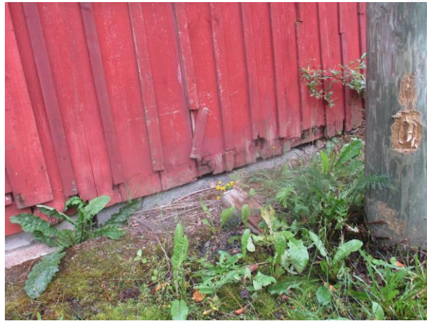
Kuva 2f. Laudoituksen alaosissa on lahoa.
