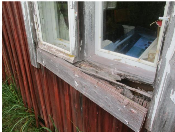
Kuva 3c. Ulompi ikkuna puuttuu. Karmi lahonnut.
