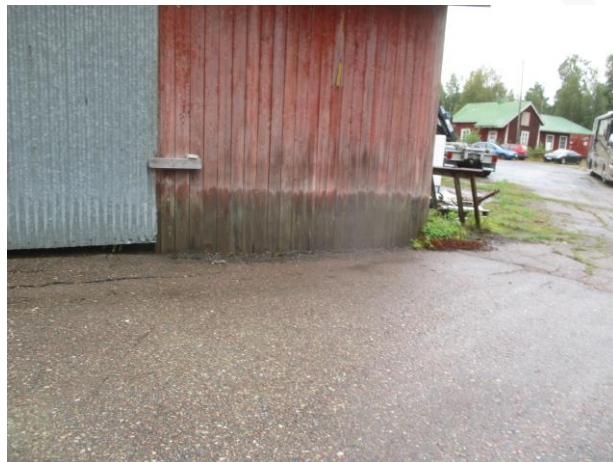
Kuva 1d. Alaosat kastuvat, koska runko ja verhous on matalalla suhteessa maanpintaan.
