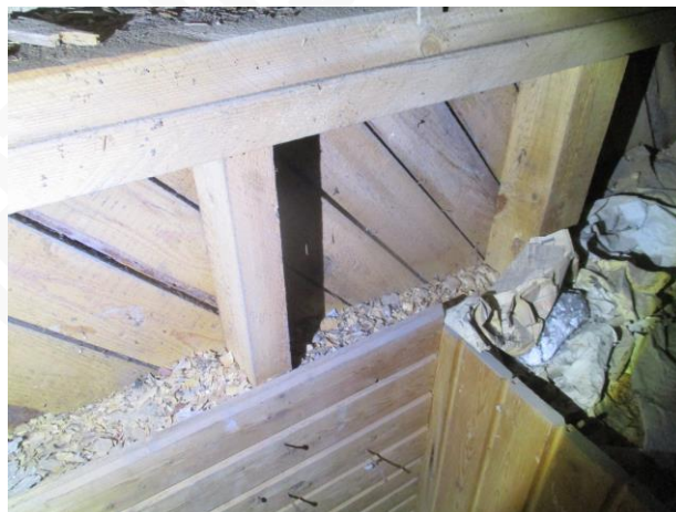
Kuva 4f. Puruntäyttöaukkoja ullakkoportaikon kohdalla.
