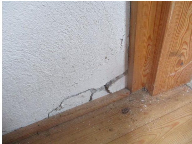
Kuva 12a. Hormissa on havaittavissa halkeama, joka viittää perustuksen vajoamiseen.
