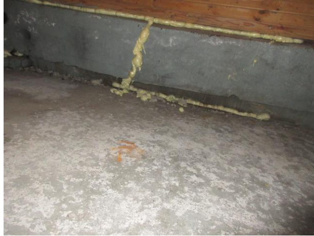
Kuva 1h. Sokkelissa oli halkeamia.
