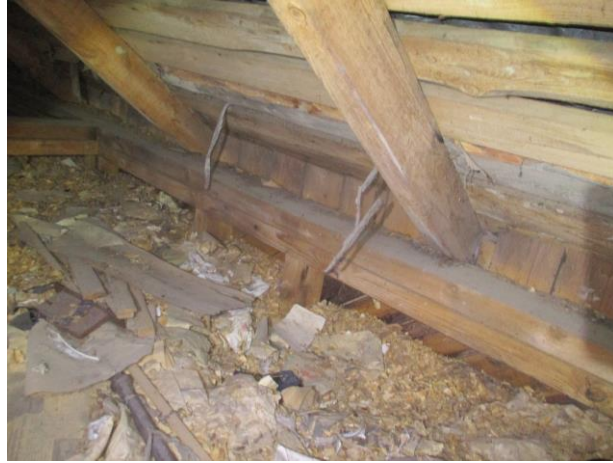
Kuva 4g. Räystäällä on rakennusajalle tavanomaisesti niukat tuuletusraot.
