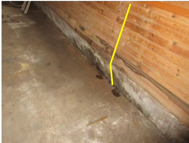
Kuva 1c. Nurjahtaminen, jota on viivalla havainnoin helpottamiseksi tehostettu. Maapohjasta sokkelin ja laatan alta johtuu irtovettä.
