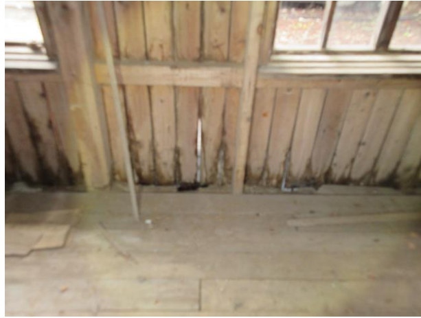
Kuva 2e. Sade ohjautuu verhouksen läpi sisätiloihin.
