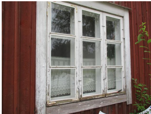
Kuva 3b. Vesipellitystä ei ole asennettu (johtuen ikkunatyypistä). Pehmentymää ikkunoiden alaosissa.
