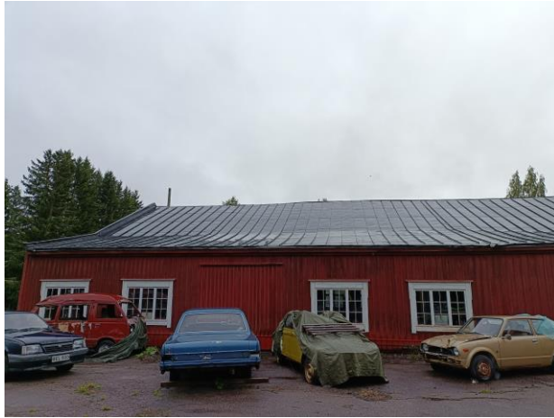
Kuva 1b. Muodon muutokset kantavissa rakenteissa ovat myös harjalinjassa todettavissa.
