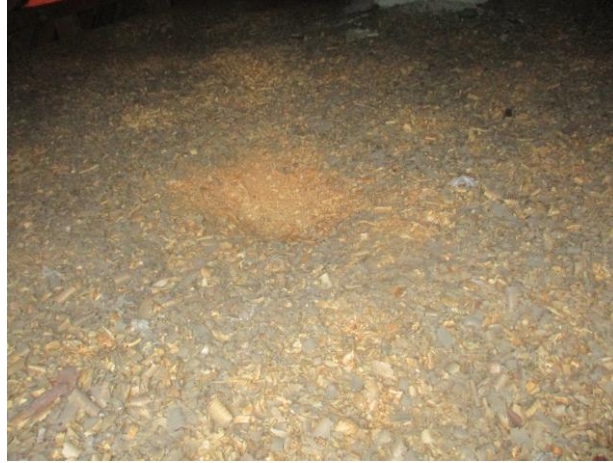
Kuva 4e. Purueriste valunut väliseinärakenteeseen.
