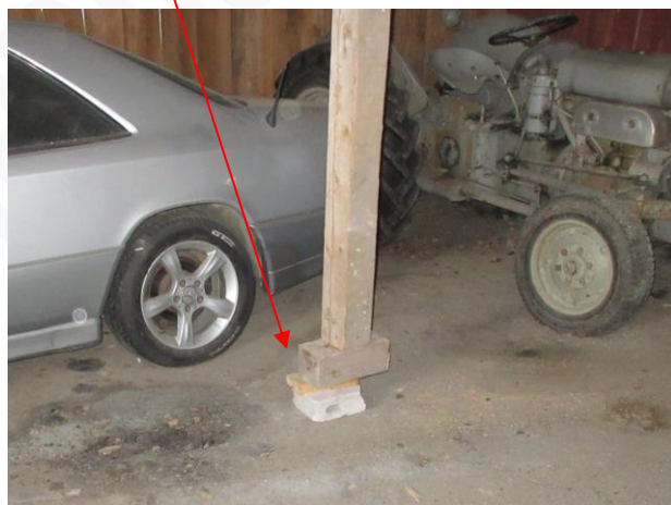
Kuva 1g. Rakennuksen liikkumisen vuoksi raken- teissa on muutoksia. Tukipilari on noussut joko katon apurungon mukana ylös tai maapohja painu- nut.
