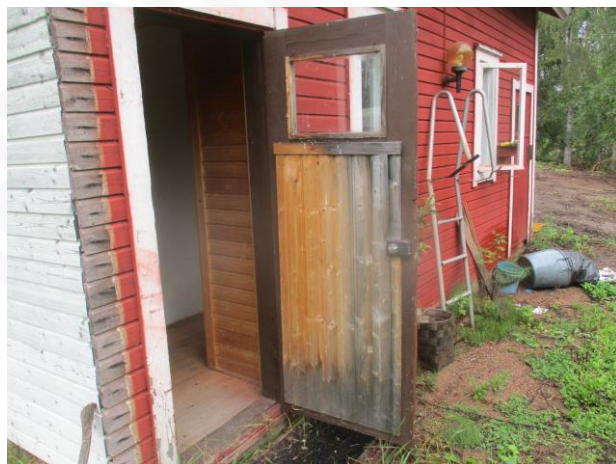
Kuva 3d. Ulko-ovet ovat kosteusvaurioituneet ja osin lahonneet.
