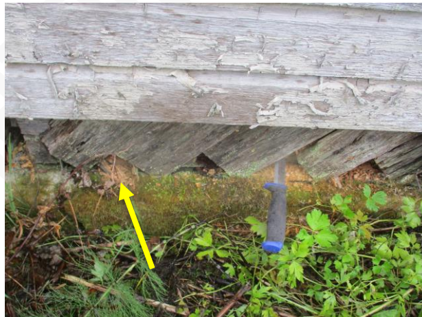
Kuva 1d. Alaohjauspuu oli paikoin laho. Vinolaudoituksessa oli myös lahoa.
