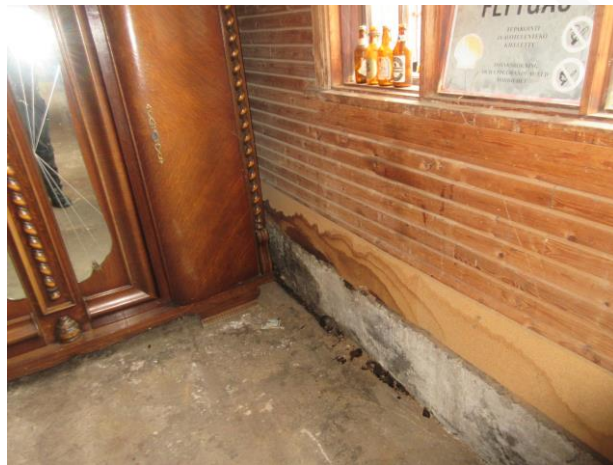
Kuva 1i. Rungon alaosat ovat paikoin hyvin märkiä
