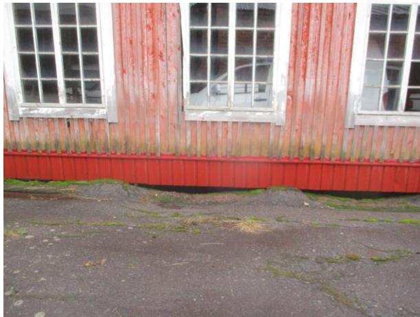
Kuva 1a. Rakennuksen vierustaa. Routiminen on nostanut asfalttia.
