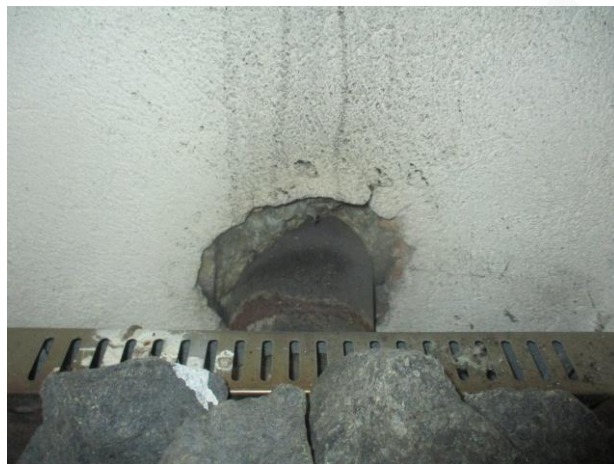
Kuva 5.2c. Palohormin läpivienti, peiteläippä puuttuu.
