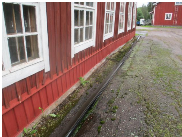
Kuva 2b. Verhouksen alaosaa oli pellitetty.
