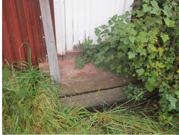
Kuva 3d. Ulko-ovi on huollon tarpeessa. Porras on lahonnut.
