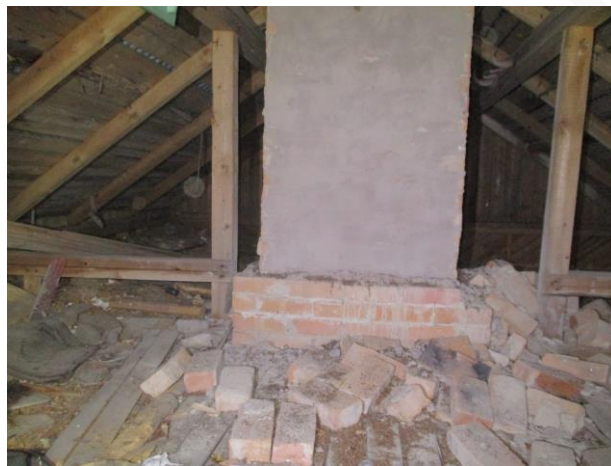
Kuva 4e. Palokuormaa ja jätettä ullakolla.
