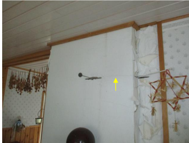
Kuva 12a. Vähäinen vaakasuuntainen hiushalkeama savupeltien välissä. Palomuurin pinnoite hilseilee.
