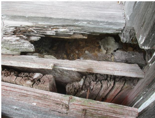
Kuva 2c. Vaurio seinärakenteessa ja ikkunan karmissa.
