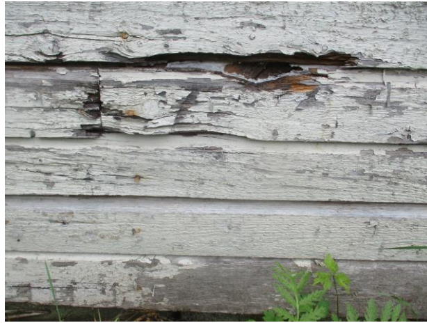
Kuva 2a. Julkisivussa on paikoin lahoa.
