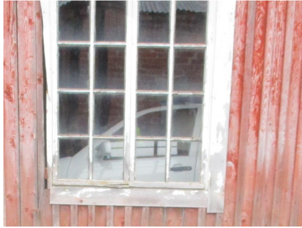
Kuva 3d. Ikkunapuitteet ja vuorilaudoitukset ovat peruskunnostuksen tarpeessa.
