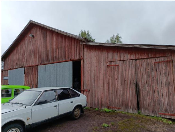
Kuva 3b. Huonokuntoinen puuovi (oikealla).
