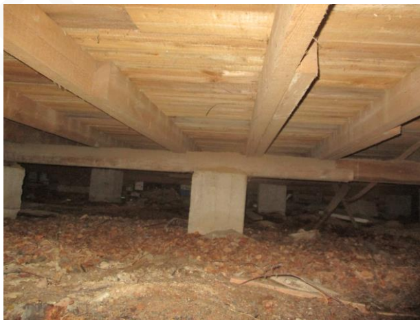
Kuva 1b. Alapohjaa. Tummentumaa tai lahoa ei havaittu, joskin alapohjasta saatiin vain osittainen havainto..
