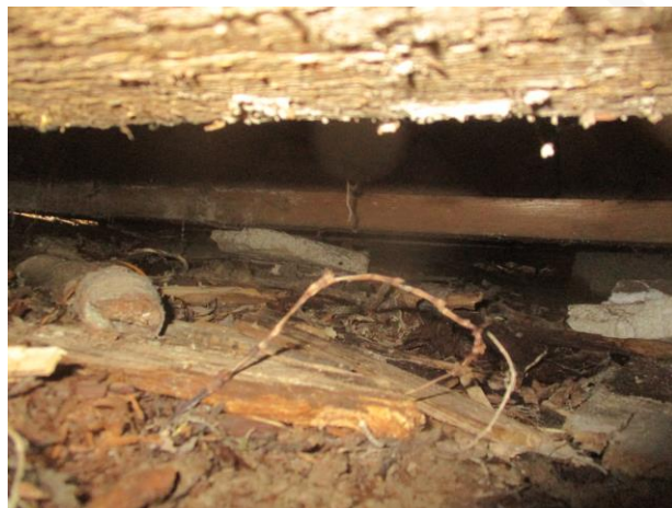
Kuva 1c. Alapohjatila on matala. Orgaanista jätettä maapohjassa.
