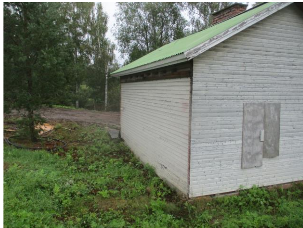
Kuva 1c. Maanpinnan viettojen tarkastelua. Rakennuksen vierustalla on kosteutta sitovaa kasvillisuutta.
