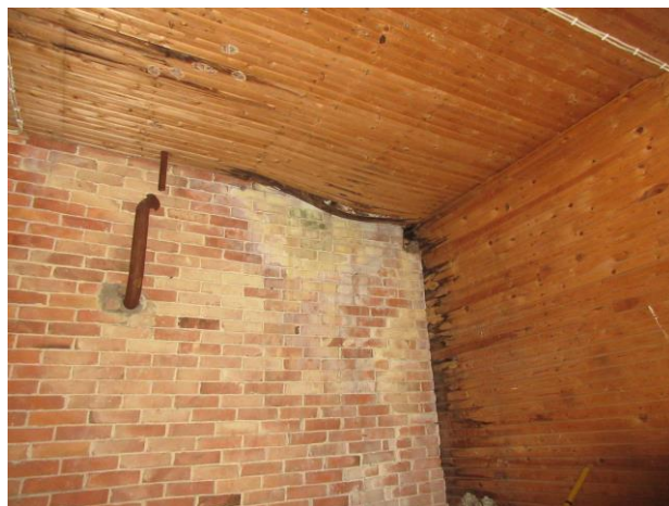
Kuva 4c. Lämmönjakohuoneen vuotokohdassa hallin puolella alakatto painunut ja vesivalunut myös väli-seinärakenteeseen.
