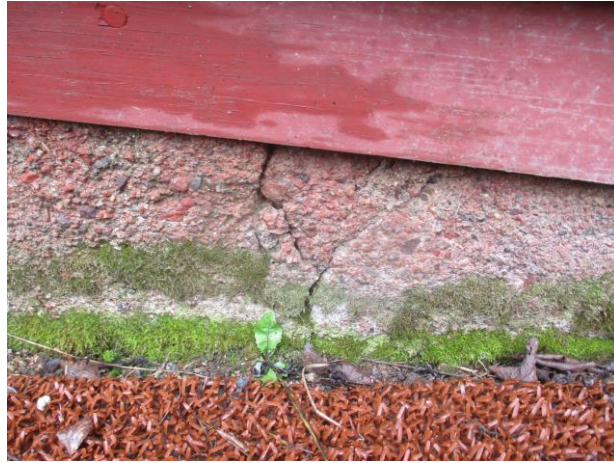
Kuva 1b. Sokkelissa oli havaittavissa halkeamia.
