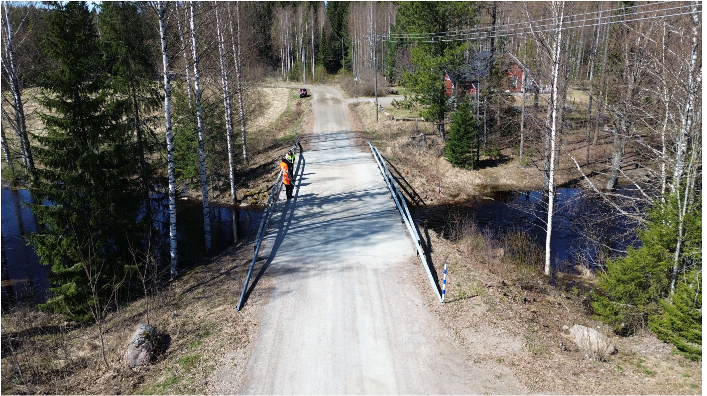
Kuva 22. Sillan kaiteet, pengerkaiteet puuttuvat
