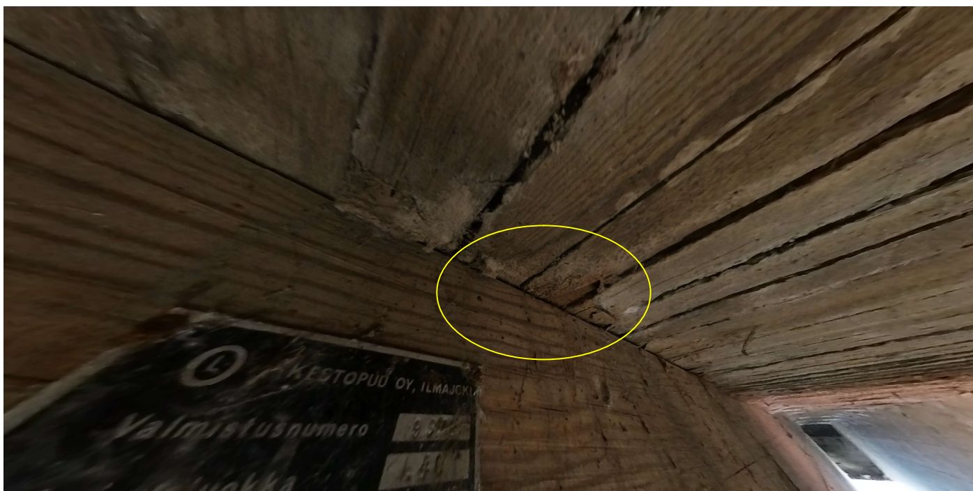
Kuva 20. Lahovaurio syrjälankkukannen alapinnalla, valkeaa sienikasvustoa.
