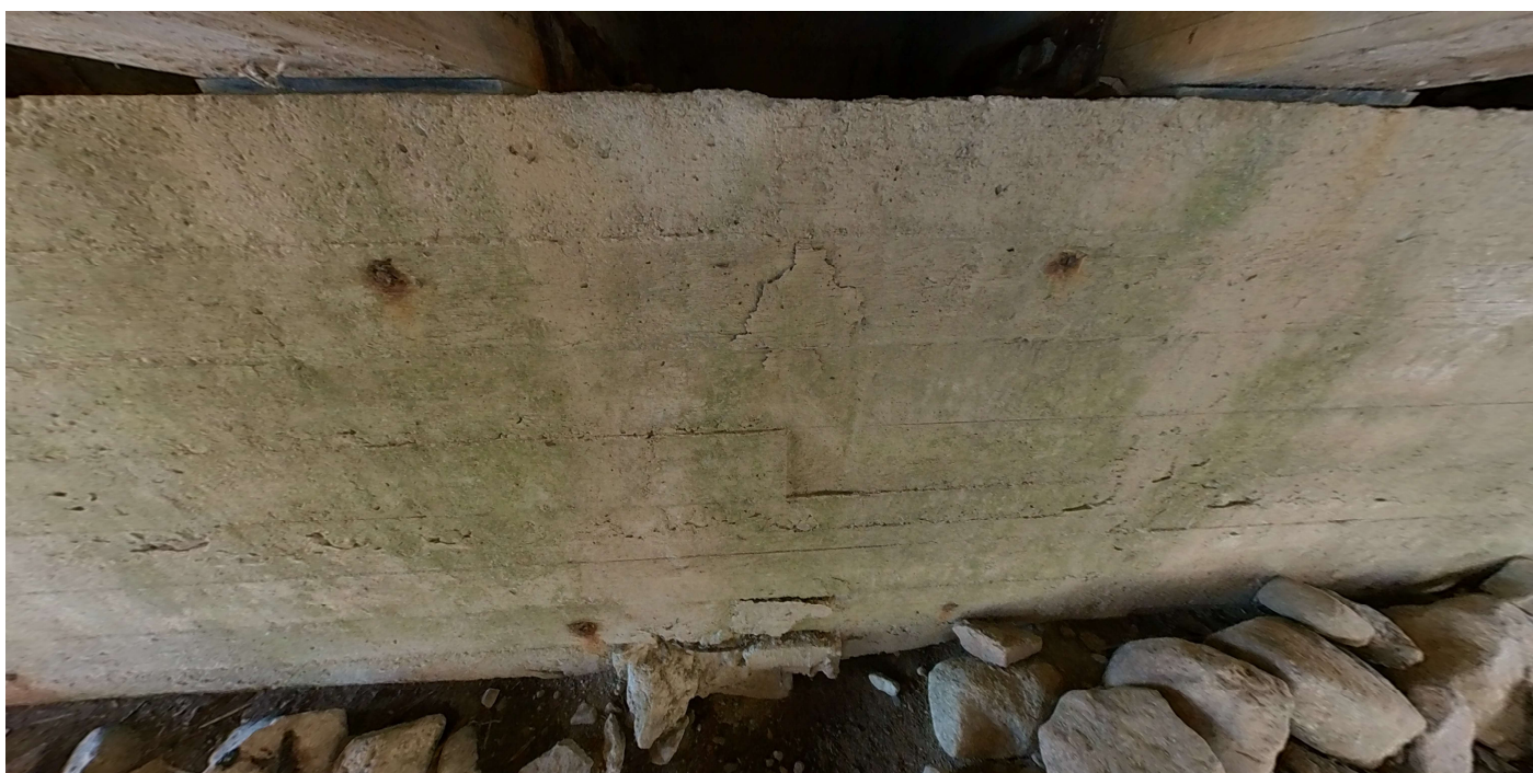
Kuva 13. Betoninen perustus ja maatuen 2 rapautumisvauriot.
