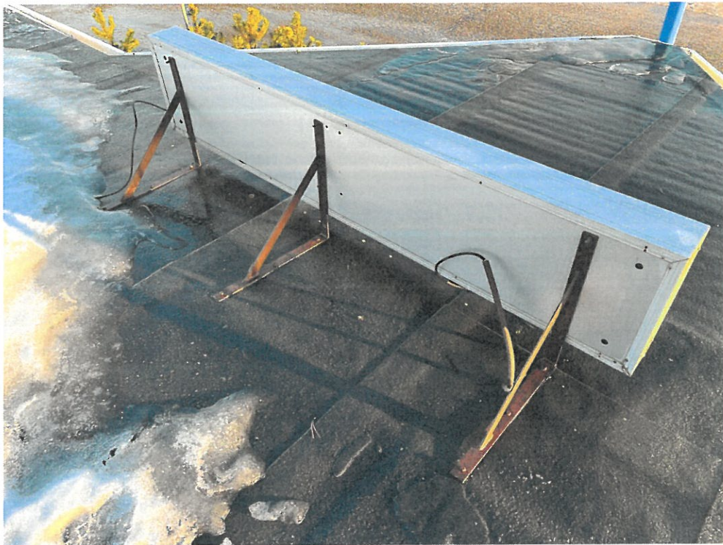
Valotaulun kiinnityskohdat on epätiivit.
