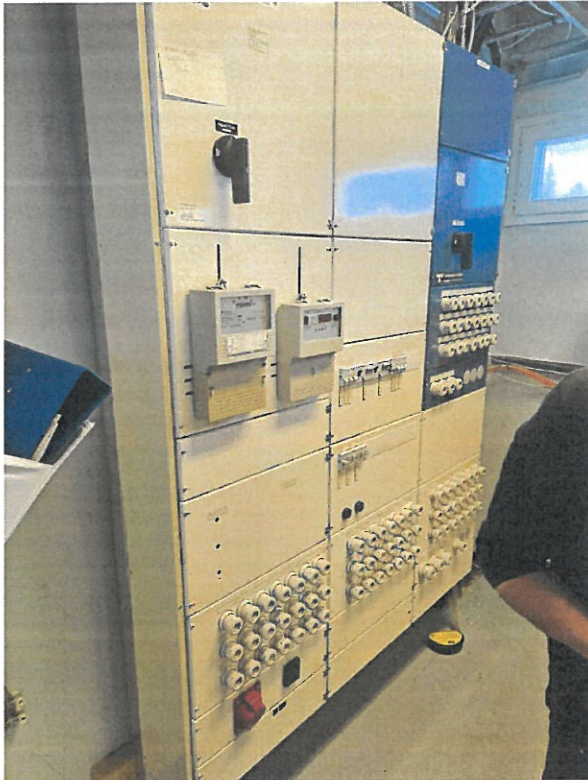
Sähköpääkeskus teknisessä tilassa.
