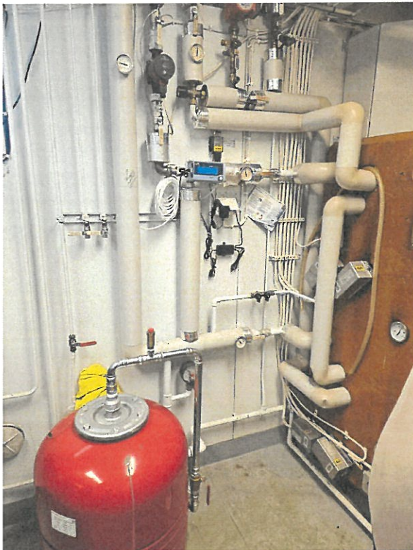
Teknisen tilan lämmitysjärjestelmä.
