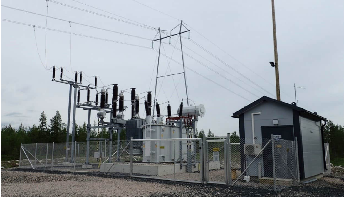
Kuva 5.10 Esimerkki tuulivoimahankkeen sähköasemasta (FCG).
