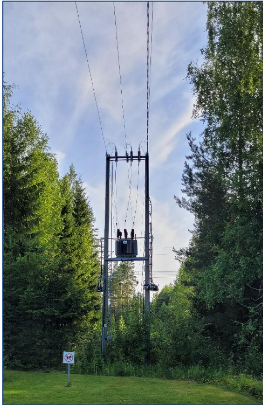
Kuva 6. Pylväsmuuntamo Teikankaan pohjavesialueella kesällä 2024.
