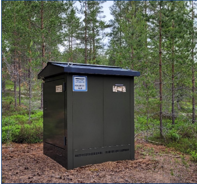
Kuva 5. Puistomuuntamo Vatulanharjulla kesällä 2024.
