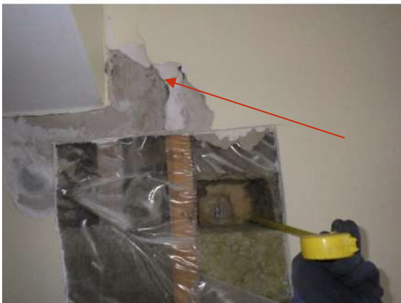
Kuva 117. Rakenneavaus RA-US14 ylimmän kerroksen aulassa, jossa on vesivuto kohta vesikaton ja ulkoseinän liittymässä. Sisäverhouslevyissä on näkyvää mikrobikasvustoa.
