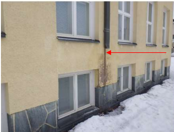
Kuva 11. Syöksytorstesta puuttuu alaosa kokonaan.
