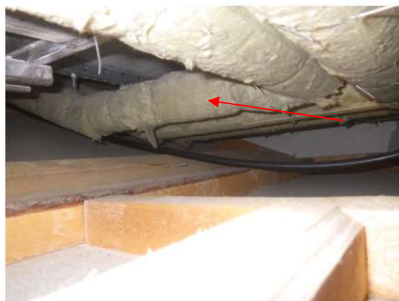
Kuva 148. Alakattotiloissa on pinnoittamattomia mineraalivillaeristeitä.
