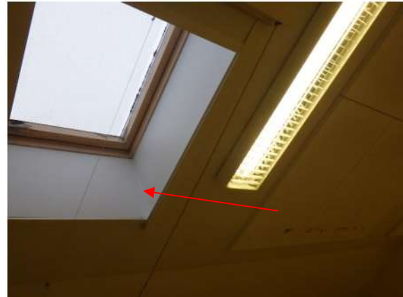
Kuva 128. Ullakkotilojen kattoikkunarakenteissa on ollut vesivuotoja lähellä ulkoseinälinjaa.
