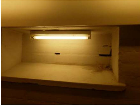
Kuva 65. Vanha umpeen muurattu ikkuna-aukko tilassa 018. Muurauksen saumat ovat slammattuja.
