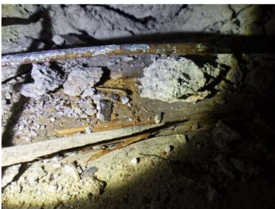
Kuva 233. Rakenneavaus RA-YP2. Täytön päällä olevassa muottilaudoituksessa on näkyvää lahoa.
