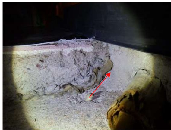
Kuva 185. Lasivillamattoa on osittain nostettu ulkoseinää vasten (punainen nuoli).
