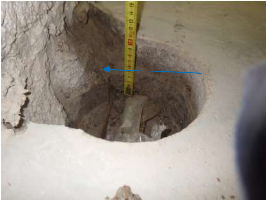
Kuva 40. Rakenneavaus RA-AP9. Rakenteessa on kaksi eri betonivalua. Betonivalun ja maanvastaisen seinän liitoksessa kuivumiskutistumasta johtuva rako.
