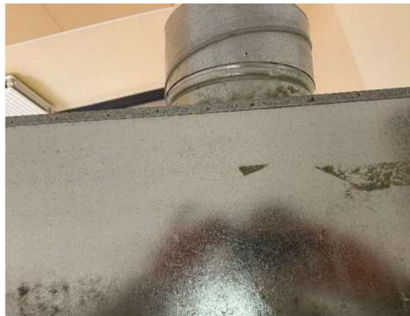
Kuva 285. Ilman virtausjäljet ovat näkyvissä päätelaittekehikon ulkopinnassa.
