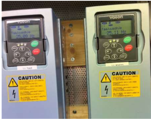
Kuva 2713. Ilmanvaihtokoneeseen on päivitetty taajuusmuuntajat vuonna 2010.
