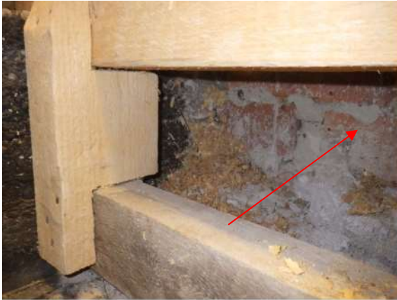
Kuva 98. Rakenneavauskohta RA-VP14. Välipohjan kohdalla ulkoseinässä ei ole betonista kuormantasauspalkkia asunto-osalla. Kuvassa näkyy ulkoseinän kantava punatiilimuuraus.
