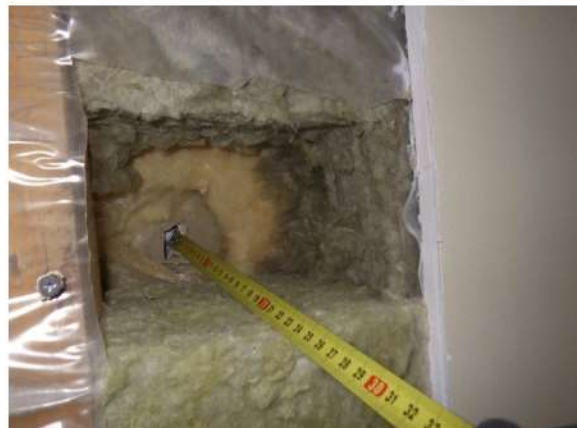
Kuva 118. Rakenneavaus RA-US14. Höyrynsulkumuovin saumat on limitetty, mutta ei teipattu.
