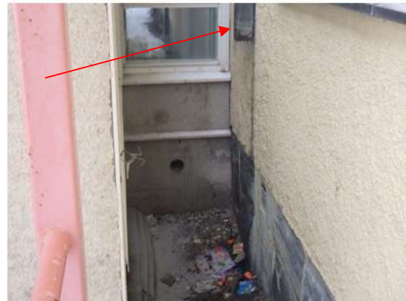
Kuva 12. Syöksytorstesta puuttuu alaosa kokonaan.
