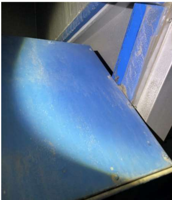
Kuva 278. Raitisilmapelti ei sulkeudu, kun koneen virrat katkaistiin. Uusintakokeessa virhe toistui.
