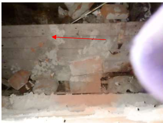
Kuva 46. Kuva rakenneavauksesta RA-POR1. Tyhjässä tilassa on paljon lahonneita muottilautoja ja rakennusjätettä.
