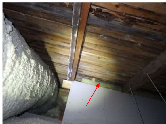
Kuva 266. Vuonna 1994 toteutettujen tilojen rakenteet heikentävät paikoin ullakon tuuletusta, kun lämmöneristeiden ja vesikaton välissä ei ole kaikkialla yhtenäistä tuuletusväliä.
