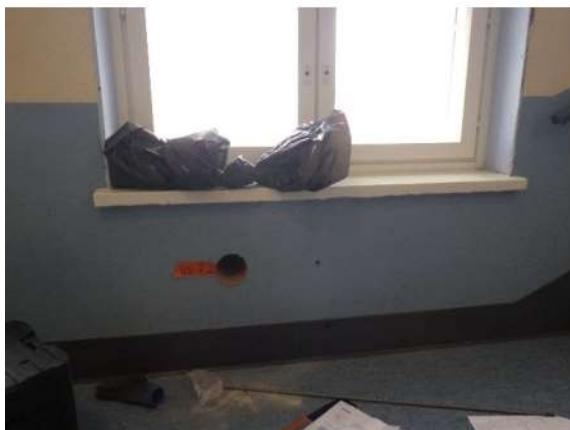
Kuva 82. Rakenneavauskohta RA-US7. Pitkillä ulkoseinillä ei ole ikkunoiden alla patterisyvennyksiä.
