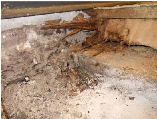
Kuva 30. Rakenneavaus RA-AP1. Ponttilautalattiassa on näkyviä lahovaurioita.
