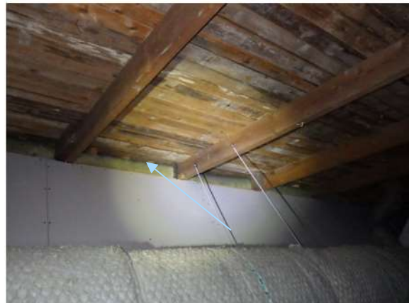
Kuva 240. Lämmöneristelevyt on asennettu lähelle vesikattorakenteita ja tuuletusväli on paikoin lähes ummessa.
