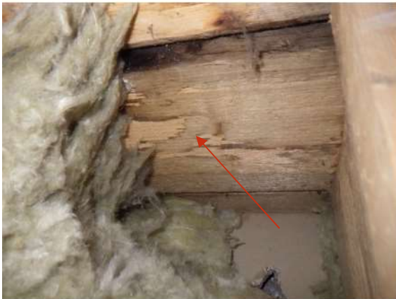
Kuva 115. Rakenneavaus RA-US1. Puurakenteissa näkyviä kosteusvaurioita.
