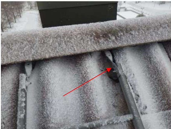
Kuva 260. Varttikatteessa on monin paikoin halkeamia ja palasia irti.
