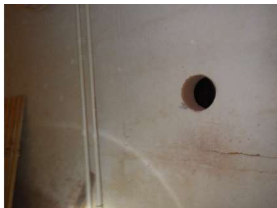
Kuva 45. Rakenneavaus RA-POR1. Portaikon alapuolisen tyhjän tilan seinää on muurattu punatiilestä. Muuraus-saumoissa on halkeilua.
