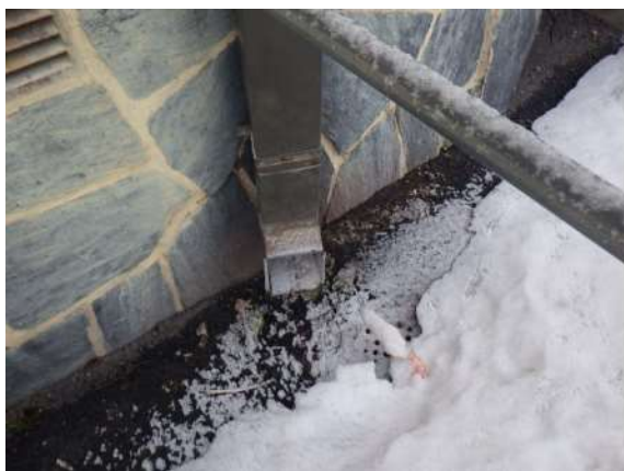
Kuva 7. Rakennuksen ympärillä maanpinnat ovat asfaltoituja. Kattosadevedet on pääosin ohjattu syöksytorvilta teräskantisiin sadevesikaivoihin.
