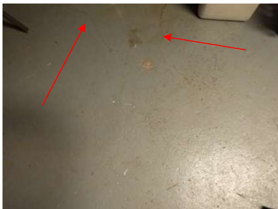
Kuva 27. Alapohjassa AP1 on paljon halkeamia.
