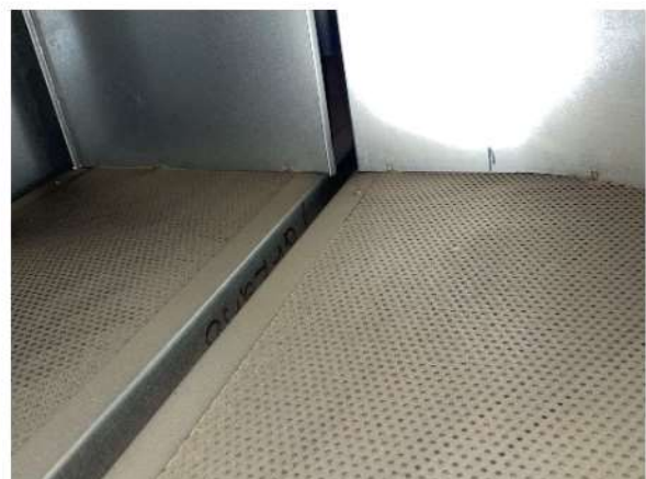
Kuva 283. Äänenvaimennuskammio on likainen ja reikäpellin takana on mineraalivillaa.
