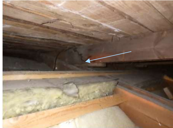
Kuva 238. Yläpohjan YP3 päällä olevassa vesikatteessa vesivuotojälkiä. Yläpohjan lämmöneristekerroksen ulkopinnassa ei ole yhtenäistä tuuletusväliä.
