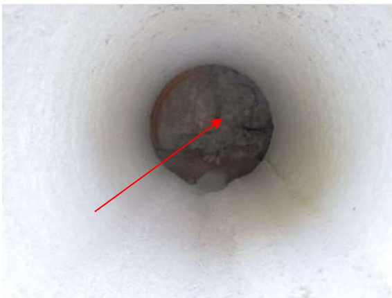
Kuva 100. Asunto-osalla välipohjan kohdalla ei ole sidepalkkia eikä kevytbetonin lisäksi muuta lämmöneristekerrosta. Kevytbetonin taustalla suoraan punatiili (punainen nuoli).
