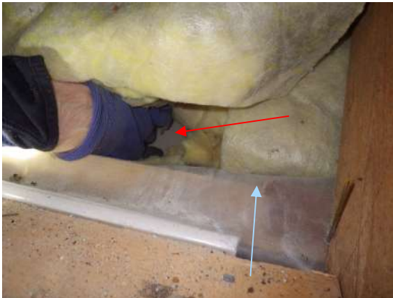
Kuva 243. Ulkoseinän höyrinsulkumuovi (sininen nuoli) ei liity ilmatiiviisti yläpohjan höyrinsulkuun. Höyrinsulkumuovien saumat on limitetty, mutta ei teipattu.
