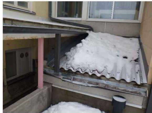
Kuva 255. Vuoden 1994 osan kellarin päällä varttikate.
