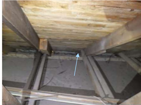
Kuva 230. Ullakotila tuulettuu räystäiden kautta, mutta tuuletusraot ovat ummessa/pienet ja tuuletuksessa on arviolta puutteita.
