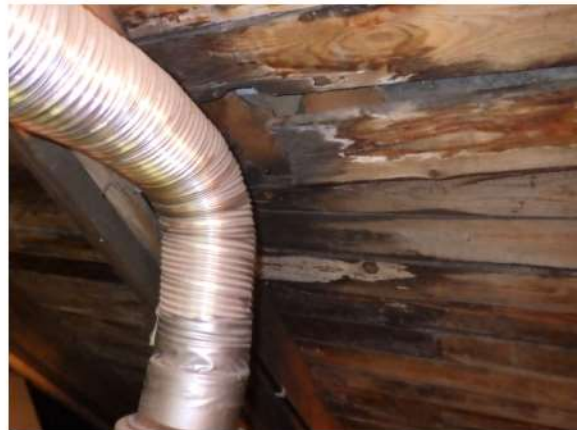
Kuva 264. Alapuolella havaittavissa useita vesivuotokohtia.
