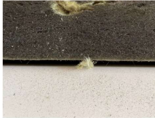
Kuva 281. Ääneneristeissä oli yksittäisiä halkeamakohtia, joista kuidut olivat näkyvissä. Kuvassa oleva repeämä on puhdistettu.
