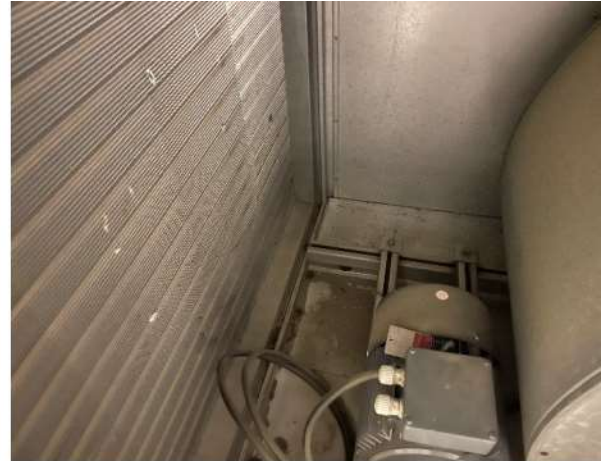
Kuva 275. Puhallinmoottorikammiossa on hiekkaa.
