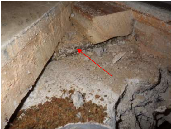
Kuva 32. Rakenneavaus RA-AP2. Ponttilautalattian alapuolinen koolaus on osittain betonirakenteen sisässä ja siinä on näkyviä lahovaurioita.
