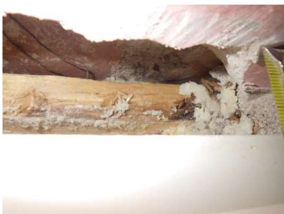
Kuva 89. Rakenneavauskohta RA-US5. Ikkunan liitoksessa on vanhaa rivettä uretaanivaahdon alla. Liitoksessa on käytetty lautaa apukarmina.
