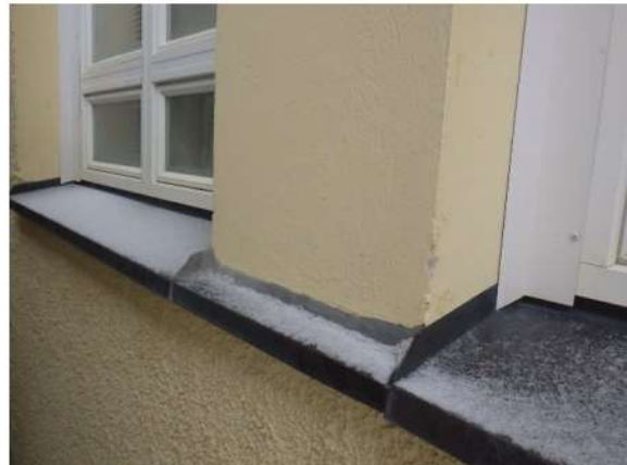
Kuva 93. Ikkunat ja ikkunapellitykset on uusittu mutta pellitysten liitoksissa on epätiiviyksiä.
