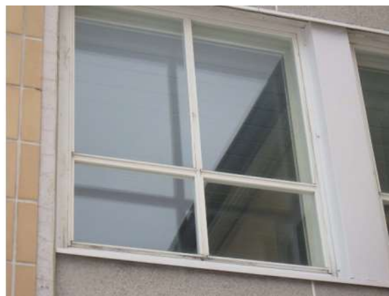
Kuva 136. Ikkunoiden ulkopuoliset osat ovat puusia ja niissä on huoltomaalauksen tarvetta.
