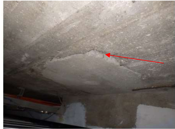
Kuva 158. Alalaatassa on paljon läpivientejä, harvvaluja, kiinnikkeitä, halkeamia sekä paikkavaluja, joiden kohdilla on näkyviä ilmavuotokohtia.
