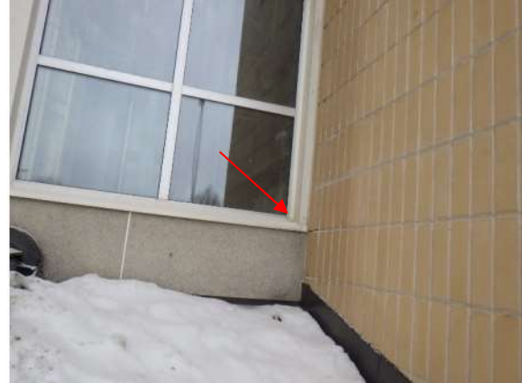
Kuva 112. Ikkunaliittymissä ja liitoksissa viereisiin rakenteisiin on epätiiviyttä.
