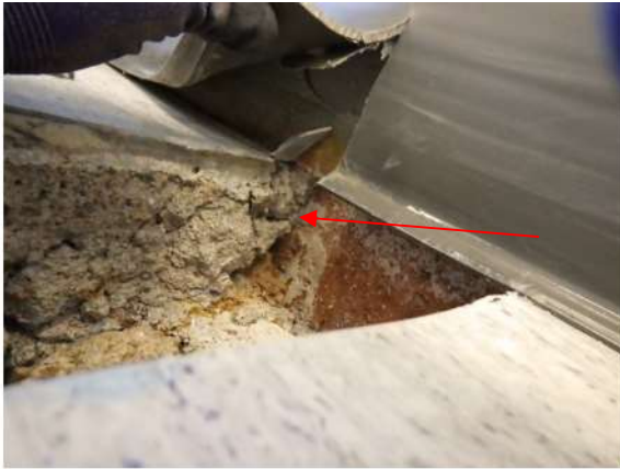
Kuva 157. Välipohjan betonikannen ja pystyrakenteiden liitoksissa ilmavuotokohtat.
