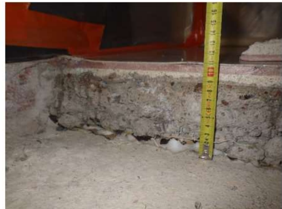
Kuva 183. Rakenneavaus RA-VP4. Rakenteessa lasivillamatto pintalaatan alla. Pintalaatan yläpinnassa magnesiassa kerrokset sekä muovimatto.
