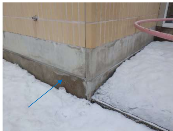
Kuva 69. Vuoden 1994 osan laajennuksen sokkelien pinnat ovat teräsbetonipintaisia, joissa on havaittavissa pintarapautumaa ja kosteusrasitusta.
