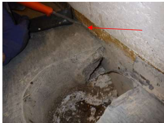
Kuva 43. Rakenneavaus RA-AP10. Betonivalun ja maanvastaisen seinän liitoksessa kuivumiskutistumasta johtuva rako.
