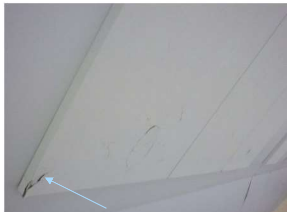
Kuva 242. Yläpohjan sisäpinnoilla akustolevyjä, jotka ovat paikoin rikki.
