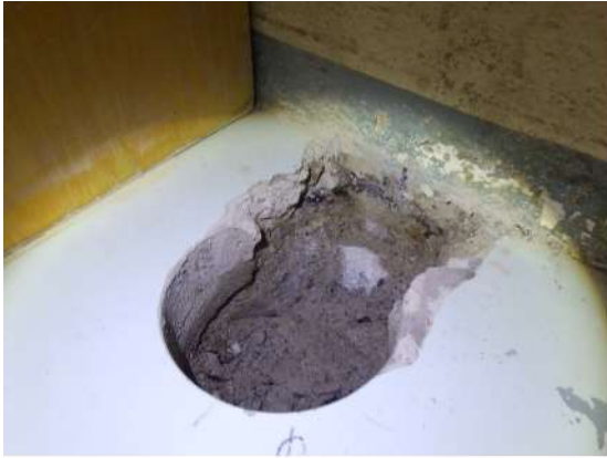
Kuva 9. Rakenneavaus RA-AP3 kantavan väliseinän liitokseen tilassa 010. Alapohjarakenne AP1 on maanvarainen ja lämmöneristämätön. Lattianpinnoitteena betonimaali, jossa kosteusrasituksesta johtuvaa hilseilyä.
