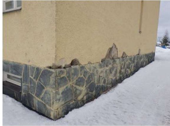
Kuva 91. Asunto-osan päädyssä julkisivurappausta ja sen alustana olevaa kevytbetonia on kaivettu.
