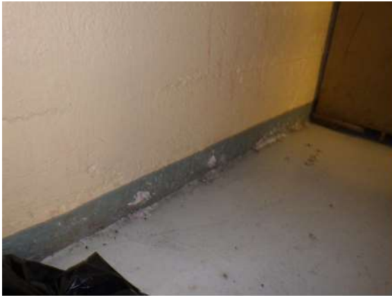
Kuva 212. Kellarissa kantavien seinien alaosissa on näkyviä tasoitekerrosten kosteusvaurioita.
