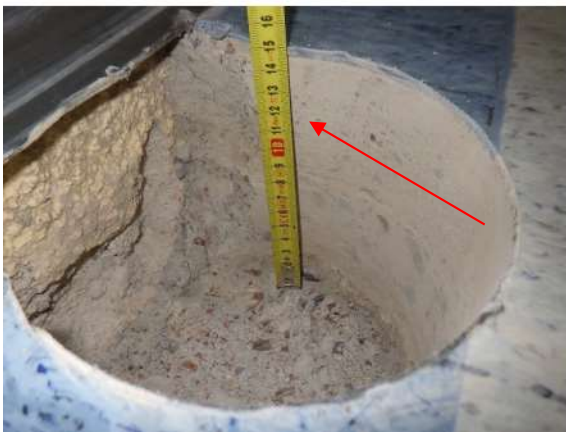
Kuva 179. Laattapalkisto on valettu vanhaa ulkoseinän rappausta vasten. Liitoksessa ei ole valuerotuskaistaa. Rakenteessa on erillinen pintalaatta kantavan rakenteen päällä. Rakenneavaus RA-VP5.
