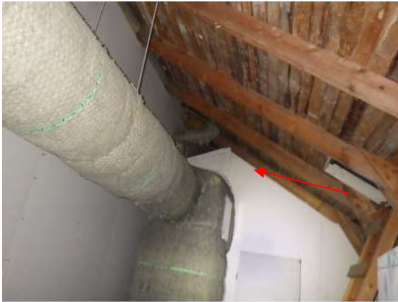
Kuva 248. Kouluosan ullakolle toteutettu IV-konehuone ja sen yläpohjarakenne merkitty punaisella nuolella.
