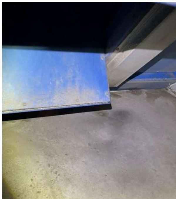
Kuva 279. Vastaava pelti kauempaa kuvattuna. Vasen pelti jäi auki, oikea sulkeutui. Peltien takana on LTO:n varauskennot.
