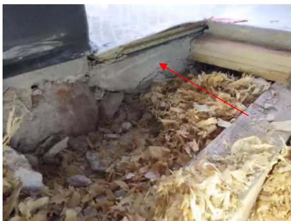
Kuva 162. Rakenneavaus RA-VP6 vuoden 1994 laajennuksen liitoksessa. Vuoden 1994 välipohjan pintalaatta on valettu vanhan ulkoseinän päälle välipohjaa VP2 vasten (punainen nuoli).
