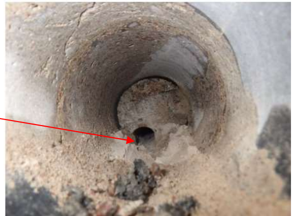
Kuva 52. Rakenteen maanpäällisellä osalla ei ole sokkelihalkaisua.
