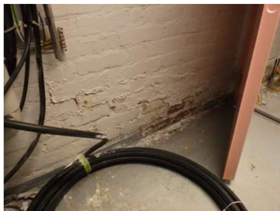
Kuva 54. Rakenteen MVS2 verhomuurauksen alaosissa on monin paikoin näkyviä tasoitekerrosten kosteusvaurioita sisäpinnalla.
