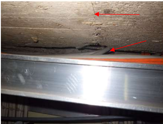
Kuva 176. Alalaatassa olevaa halkeilua sekä sähköjohtojen läpivientien näkyviä reikiä täyttökerrokseen.
