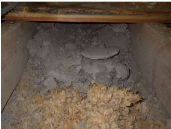
Kuva 170. Täyttökerroksena kutterinlastun lisäksi laastijätettä.
