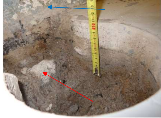
Kuva 10. Rakenneavaus RA-AP3. Punaisella nuolella merkitty kantavan seinän anturarakente. Alapohjan pintabetonilaatta on valettu anturan päälle. Kantavan seinän alaosissa on näkyviä tasoitteiden kosteusvaurioita (sininen nuoli).
