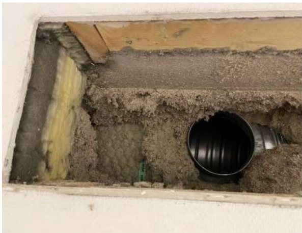
Kuva 284. Päätelaitelaatikkoa ei ole kiinnitetty lainkaan väliseinän runkoon.
