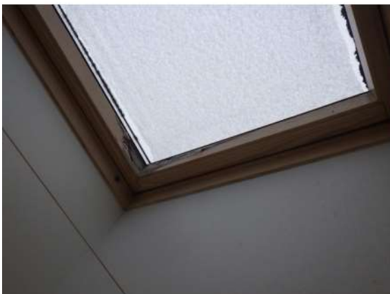
Kuva 241. Yläpohjarakenteessa YP3 on kattoikkunoita, joissa on vesivuotoja.
