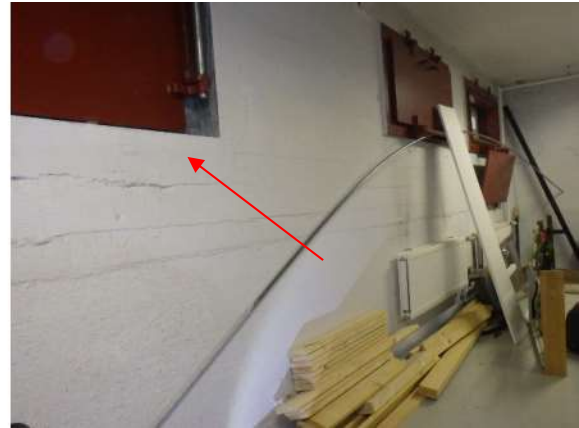
Kuva 64. Maanvastaisen seinän aukotusten kohdilla on tehty paikallisia valukorjauksia vanhaan säästökivibetonirakenteeseen, jotta aukotukset on saatu toteutettua tilan käyttötarkoituksen mukaisesti.
