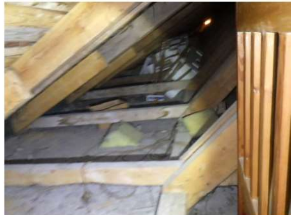
Kuva 224. Yläpohjan päällä ullakkotilassa on paljon rakennusjätettä ja varastoitua tavaraa.
