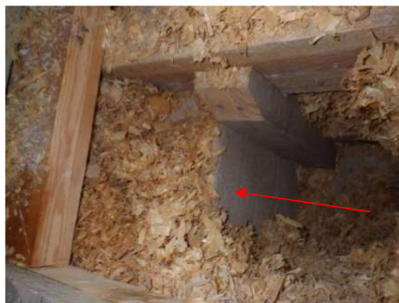
Kuva 163. Rakenneavaus RA-VP6. Toisessa ja kolmannessa kerroksessa välipohjassa ei ole bitumisivelyä.
