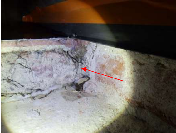
Kuva 187. Pintabetonilaatan ja ulkoseinän liitoksissa rakoilua.
