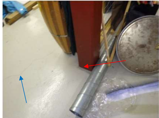
Kuva 41. Tilassa 014 on tehty teräspilari-vahvistuksia keskelle tilaa, joilla on tuettu tilan yläpuolella olevaa välipohjarakennetta, kun sen kuorma on kasvanut väestönsuojaksi muuttamisen myötä. Alapohjalaatassa on halkeilua.
