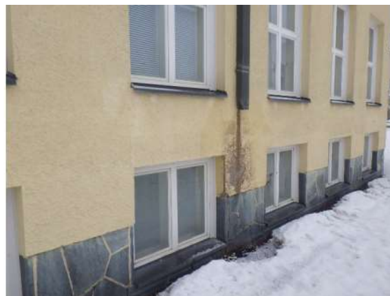
Kuva 75. Kouluosan julkisivun maalipinta monin paikoin kulunut. Syöksytörvia aiheuttaa kosteusrasitusta ulkoseinälle. Ikkunat ja ikkunapellitykset on uusittu.
