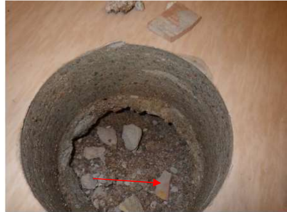
Kuva 191. Rakenneavaus RA-VP17. Pinta-laatta on arviolta uusittu, mutta täyttökerroksessa on vanhoja rakennusjätteitä, joiden seassa saattaa olla asbestia sisältäviä materiaaleja.
