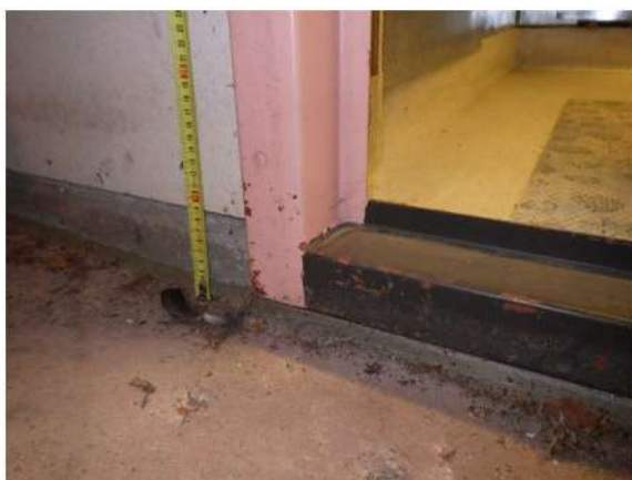
Kuva 206. Kuva tilan 405 IV-konehuoneen ovelta, jossa IV-konehuoneen lattia on tehty vanhan asunto-osan yläpohjan päälle.
