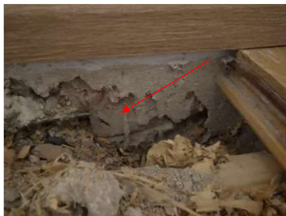
Kuva 161. Rakenneavaus RA-VP7. Ulkoseinän kohdalla ei välipohjan sidepalkkia.
