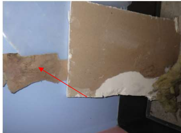
Kuva 116. Sisäverhouskipsilevyssä on näkyvää mikrobikasvustoa.
