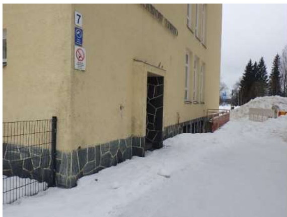
Kuva 74. Kouluosan julkisivurappauksen maalipinta on kulunut ja siinä on likaantumista sekä rapautumavaurioita.
