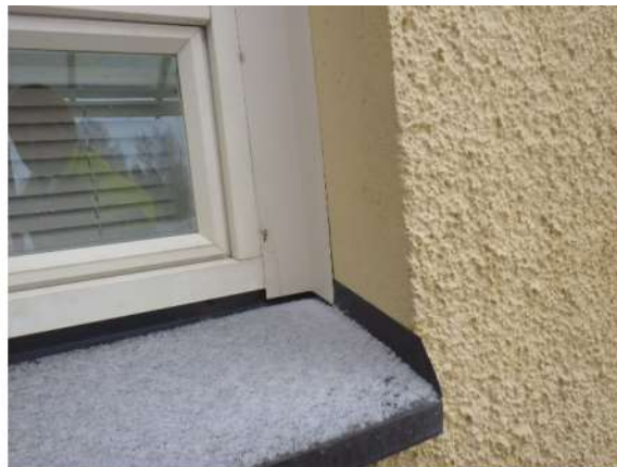
Kuva 132. Ikkunapellitysten liitoksissa on epätiiviyyttä, mikä aiheuttaa rappausten vaurioita.
