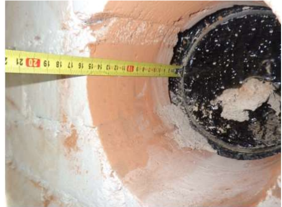
Kuva 50. Rakenneavaus RA-MVS2. Tila-kohtaisesti verhomuurauksen sisäpinnassa on vain maalikerros ja verhomuurauksessa on halkeamia muuraus-saumoissa.
