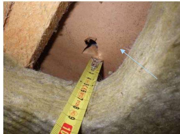
Kuva 247. Ulkopinnassa on tuulensuoja-pintainen kova mineraalivilla ja 50 mm tuuletusrako aluskatteen alla. Aluskatteen alapinnassa on mikrobikasvusto.
