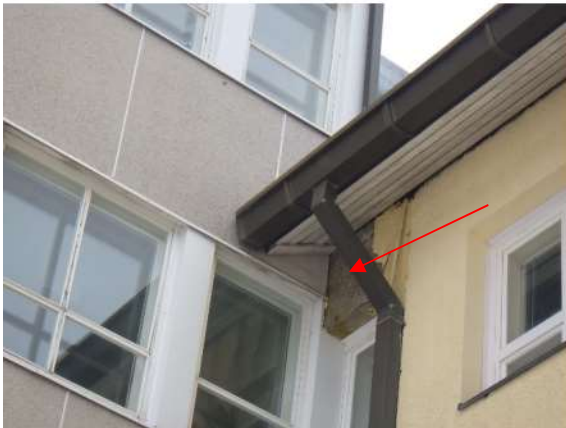
Kuva 92. Sadevesijärjestelmän aiheuttamia rapautumavaurioita julkisivulla.
