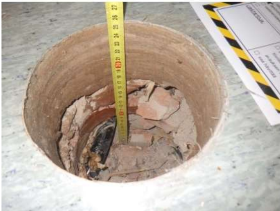
Kuva 153. Välipohjan rakenneavaus RA-VP15 luiskassa 139. Luiskassa on rakennusjätettä täyttökerroksena eikä luiskassa ole magnesiamaassaa. Avauskohdassa rakennusjättekerroksen paksuus 170 mm.
