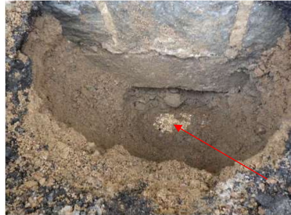
Kuva 18. Koekuoppa KK1. Rakennuksen vierelle on toteutettu vaakasuuntainen routaeristys 100 mm vahvuisella EPS-eristeellä.
