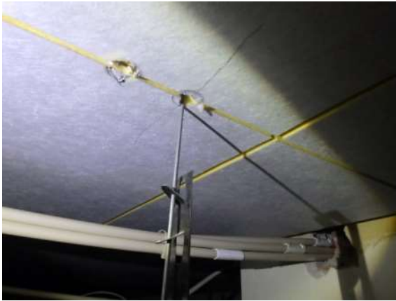
Kuva 235. Alakattotiloissa on pinnoittamattomia mineraalivillaeristeitä vanhoissa akustolevyissä ja putkieristeissä.
