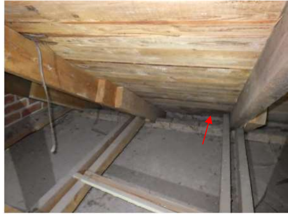
Kuva 262. Asunto-osalla tuuletusrako on räystäällä lähes ummessa.
