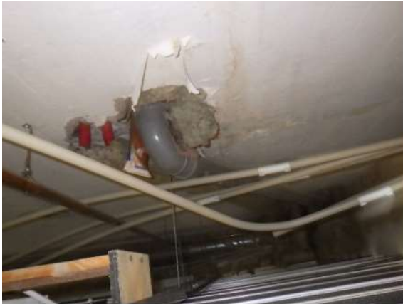
Kuva 174. Alalaattapalkistossa olevia läpivientejä, joiden kohdilla näkyviä ilma- vuotoja.
