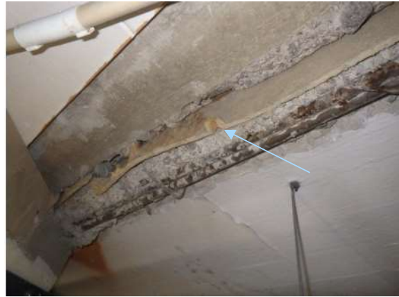
Kuva 236. Asunto-osan yläpohjassa oleva liikuntasauva, jossa kovalevyä.
