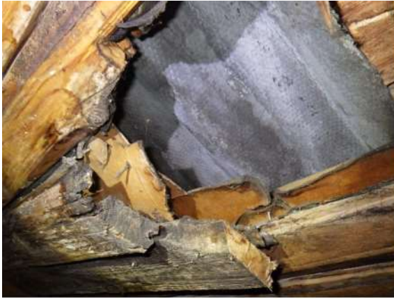
Kuva 261. Aluskatteessa on reikiä ja epätiiviyiskohtia.
