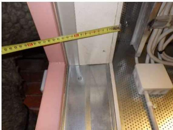
Kuva 129. Ullakolle vuonna 1994 tehdyn IV-konehuoneen seinärakenne. Kuva asunto-osan ullakolle toteutetusta tilasta 405.
