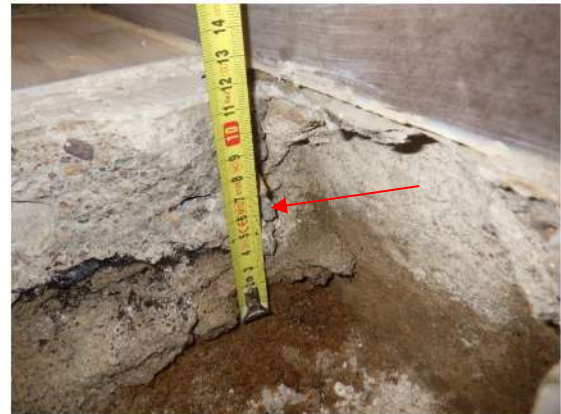
Kuva 24. Rakenneavaus RA-AP4. Alapohjarakenteen ja kantavan betoniväliseinän liitoksessa on kuivumiskutistumasta johtuva rako (punainen nuoli).
