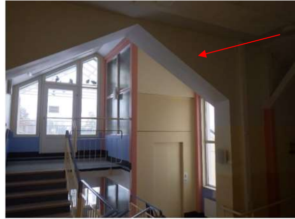
Kuva 122. Vanha ulkoseinärakenne US1 vuoden 1994 laajennuksen ja kouluosan välillä (punainen nuoli) ylimmässä kerroksessa.
