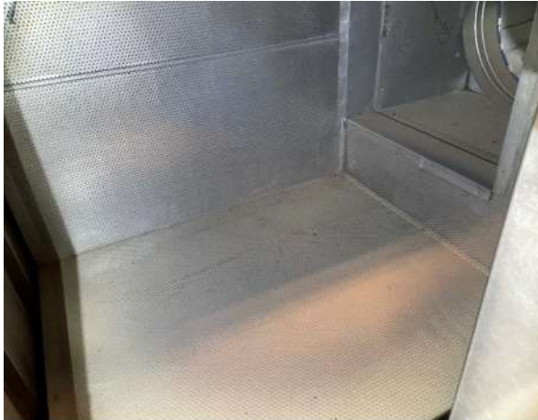
Kuva 274. Ilmanvaihtokoneen paineensauskammion lattiapinnalla on näkyvä kerrostuma ulkoilman pölyä.
