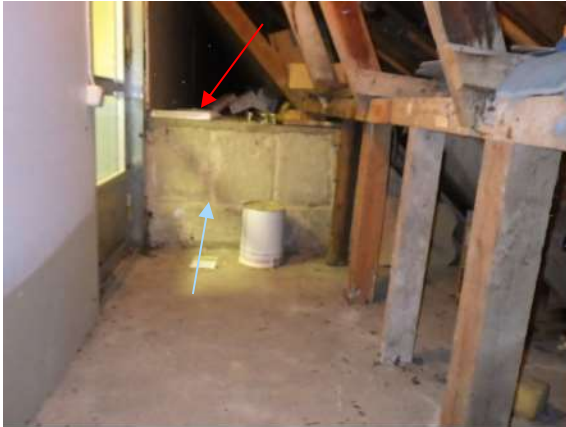
Kuva 221. Rakenneavauskohta RA-YP1 (punainen nuoli). Yläpohjassa eri tasoja, minkä vuoksi yläpohjassa YP1 on myös pystysuunnassa kevytbetonieristettyjä kohtia (sininen nuoli).
