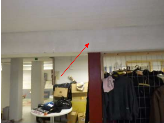
Kuva 194. Tilan 118 alapuolella olevassa väestönsuojassa 014 on väestönsuojan kattorakennetta tuettu teräspilarein ja teräspalkein. Palkit on levyverhottu.
