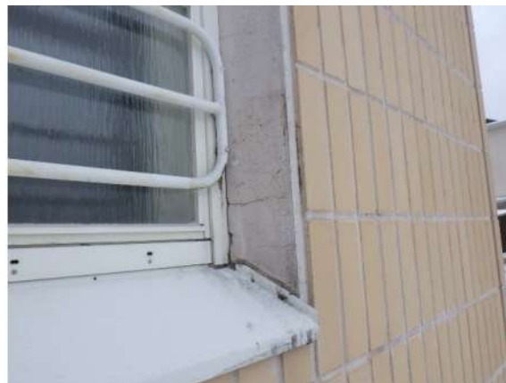
Kuva 106. Elementtien pinnoilla ei merkittävää halkeilua. Ikkunaliittymissä on epätiiviyyttä.
