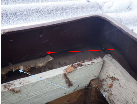
Kuva 258. Kuitusementtiaaltokatteen alla pahvinen aluskate (punainen nuoli), jonka alla alkuperäinen bitumikermialuskate.
