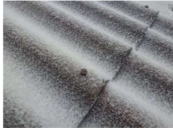
Kuva 259. Varttikatteen kiinnityksissä epätiiviyttä ja ne ovat paikoin huonosti kiinni.
