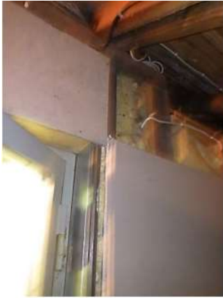
Kuva 125. Ulkoseinärakennetta US7 kylmää ullakkotilaa vasten. Rakenteesta puuttuu tuulensuojakipsilevytystä seinän yläosasta.
