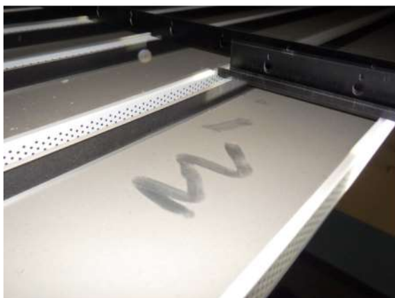
Kuva 147. Alakattotiloissa on runsaasti pölykertymää.
