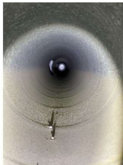
Kuva 287. Ilmanvaihtokanavissa on näkyvää karkearakeista pölyä.
