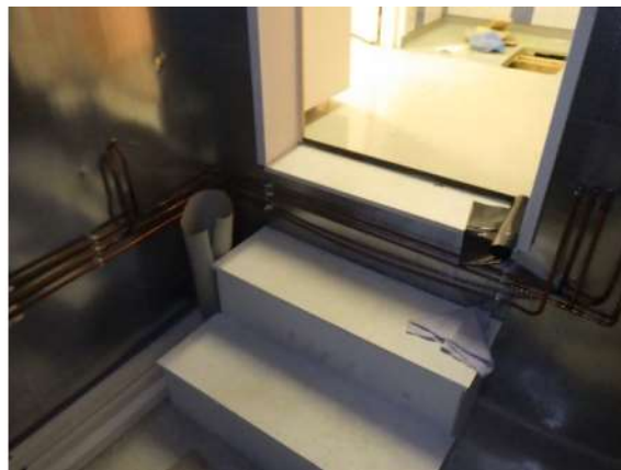
Kuva 130. Kuva kouluosan ullakolle toteutetusta IV-konehuoneesta 506.
