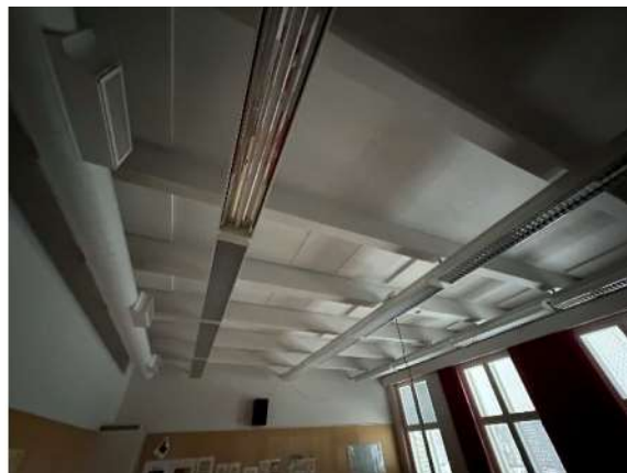
Kuva 228. Ylälaattapalkiston alapinnan ilmavuotokohtat liittyvät pääosin läpivienteihin ja kiinnikkeiden kohdille.
