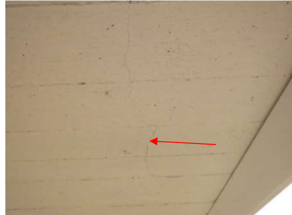
Kuva 175. Alalaattapalkiston alapinta ei ole ilmatiivis rakenne, koska se on ohut rakenne ja siinä on halkeilua.
