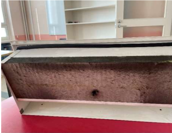
Kuva 280. Seinään asennetuissa tuloilman päätelaitteissa on ääneneristeenä suojamatonta mineraalivillaa.
