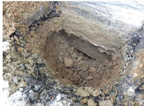
Kuva 16. Koekuoppa KK2. Routaeristeen päällä on karkeaa maa-ainesta raekooltaan noin 0-32 mm. Maanvastaisen seinän ulkopintaan ei ole asennettu vedeneristystä tai lämmöneristystä.
