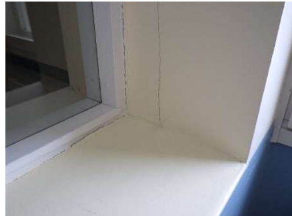
Kuva 12. Vanhassa ulkoseinärakenteessa on karmirakenteet, joiden liitoksissa on näkyviä rakoja.
