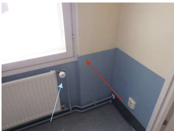
Kuva 109. Teräsbetoninen sisäkuori (punainen nuoli). Sinisellä nuolella merkitty US4, joka liittyy rakenteeseen US3.
