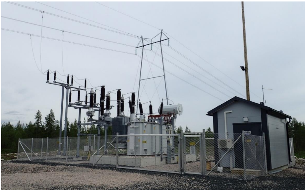
Kuva 9.7. Esimerkki tuulivoimahankkeen sähköasemasta (Minna Takalo, FCG).
